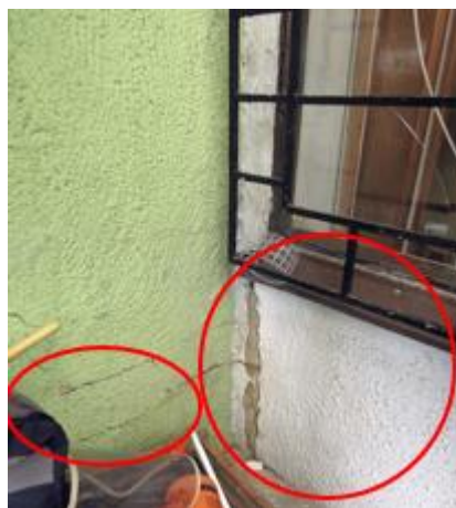
Ilustración 10. Falla 3. Fuente de la imagen: Autores.
