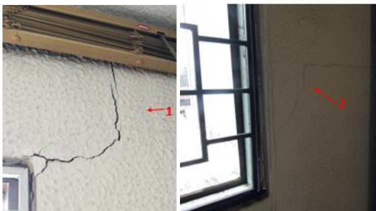
Ilustración 16. Falla 6 Fuente de la imagen: Autores.
