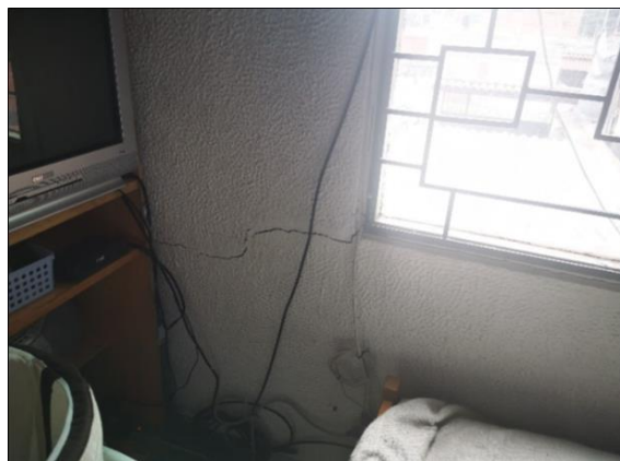
Ilustración 25. Grieta en muro de alcoba de segundo piso. Fuente de la imagen: Autores.
