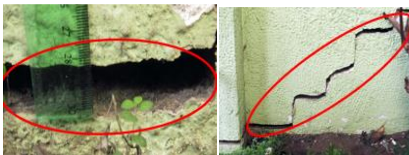
Ilustración 8. Falla 2. Fuente de la imagen: Autores
