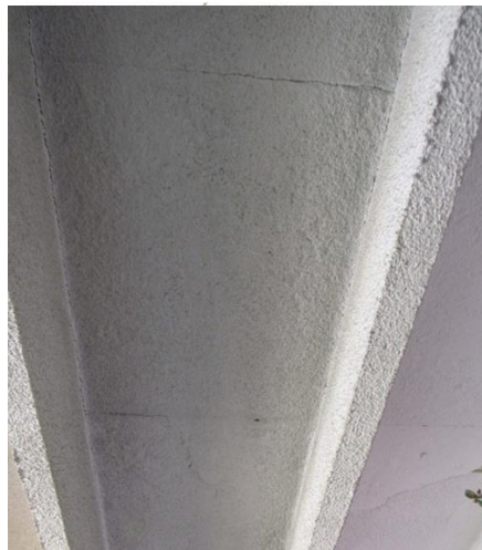
Ilustración 18. Falla 7. Fuente de la imagen: Autores.
