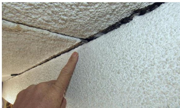
Ilustración 22. Falla 9. Fuente de la imagen: Autores.
