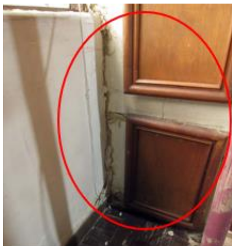
Ilustración 12. Falla 4. Fuente de la imagen: Autores.
