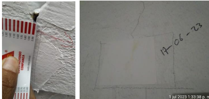
Ilustración 26. Testigos de yeso en fisuras sin rotura
