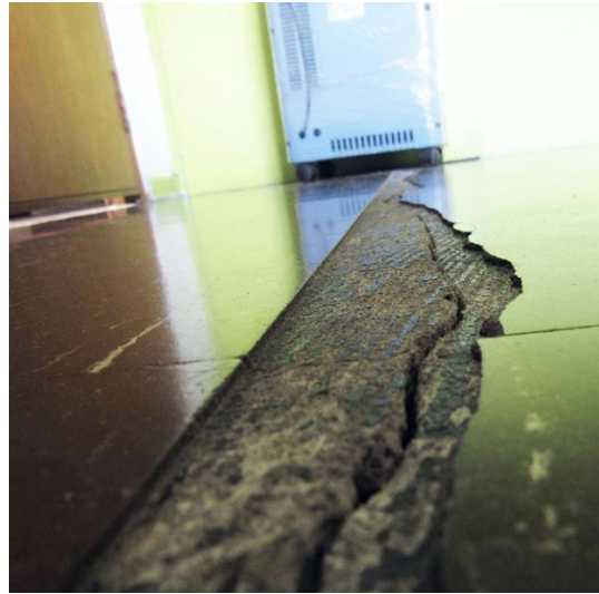
Ilustración 20. Falla 8. Fuente de la imagen: Autores.
