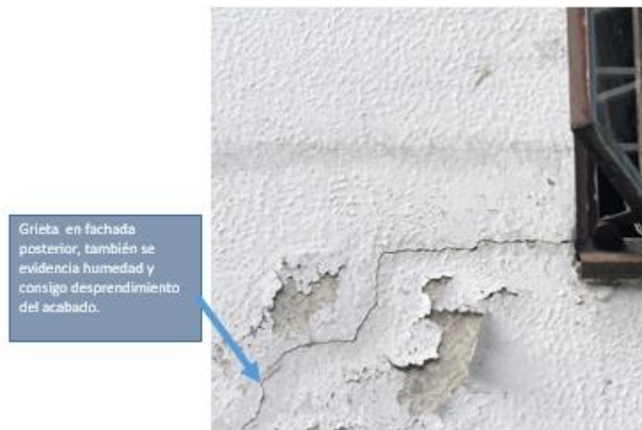
Ilustración 24. Falla 10. Fuente de la imagen: Autores.
