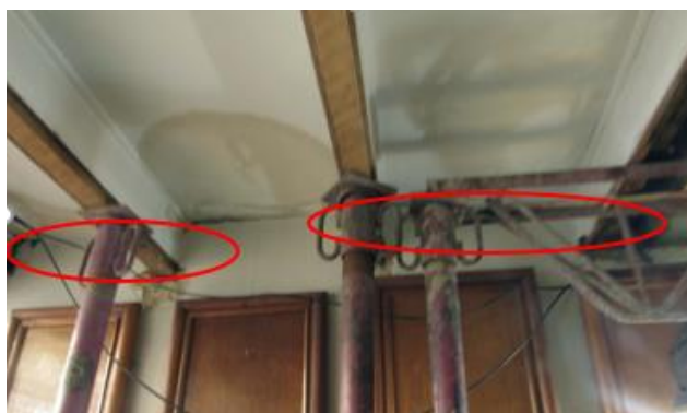
Ilustración 6. Falla 1. Fuente de la imagen: Autores.
