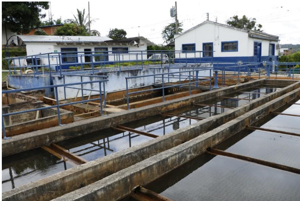
Figura 1. Planta de tratamiento de agua potable - ESPL
