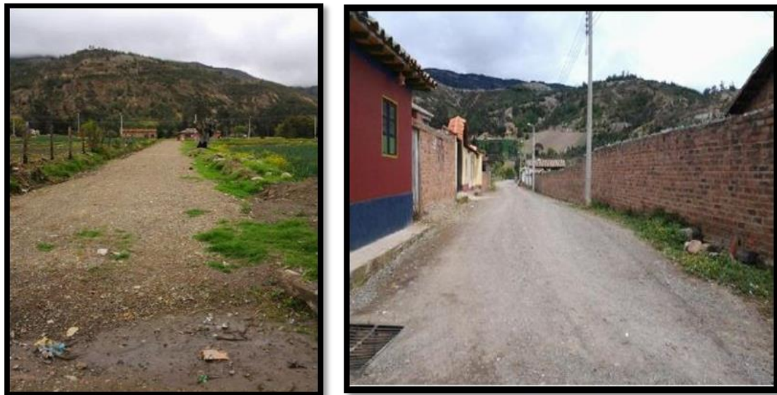
Ilustración 24 Vías Sin pavimentar y en mal estado Fuente: El Autor
