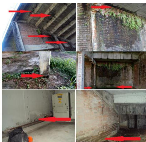
Figura 12. Lesiones por filtración y capilaridad Fuente: Autor
