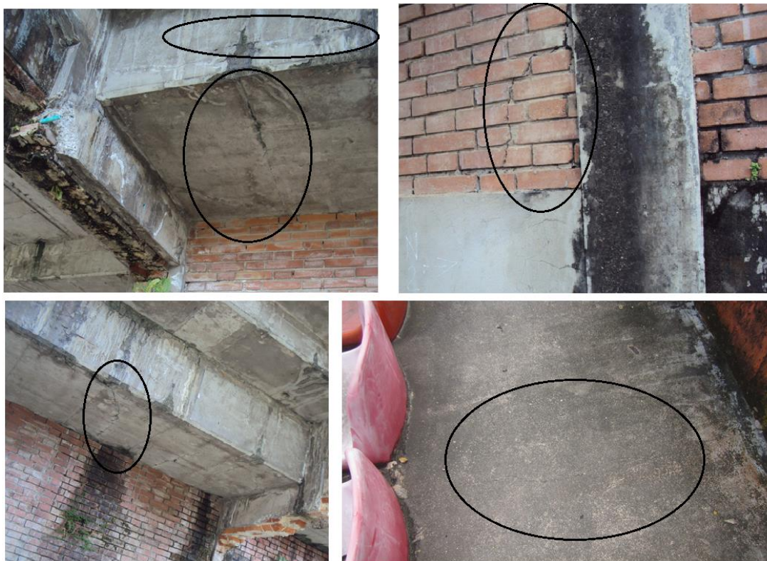
Figura 15. Lesiones por fisuras Fuente: Autor
