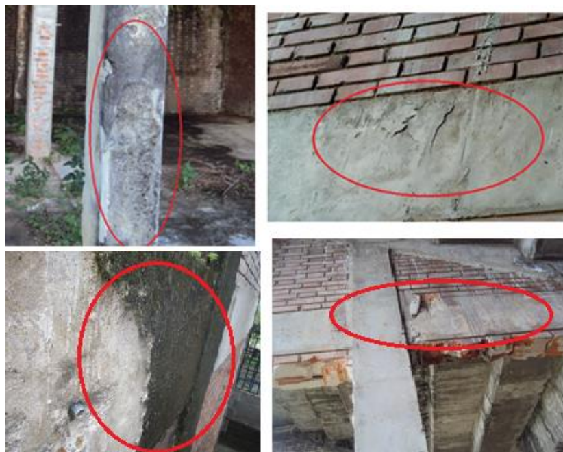
Figura 14. Lesiones por desprendimiento Fuente: Autor
