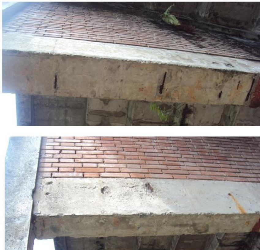
Figura 19. Lesiones por oxidación Fuente: Autor
