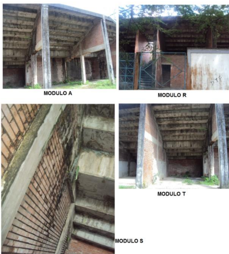
Figura 23. Módulos con mayor afectación de corrosión Fuente: Autor
