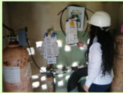
Ilustración 18 Planta de tratamiento de agua de Belén, Caseta de cloración. Fuente: Propia.
