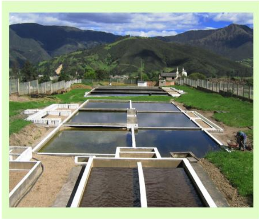
Ilustración 14 Planta de tratamiento de agua potable de Belén. Fuente: Plan Maestro Servibelén E.S.P
