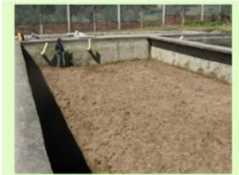
Ilustración 17 Planta de tratamiento de agua potable de Belén, Filtro lento. Fuente: Propia.
