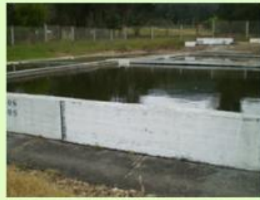
Ilustración 16 Planta de tratamiento de agua potable de Belén, Filtro grueso. Fuente: Propia.
