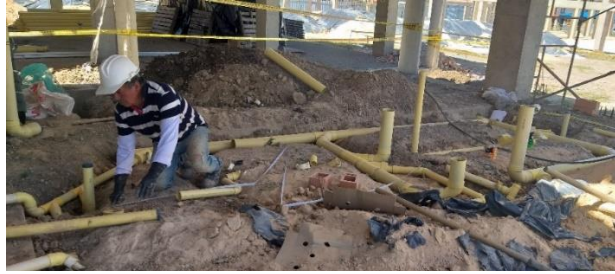
Figura 41. Arreglo de tubería instalada con fugas
