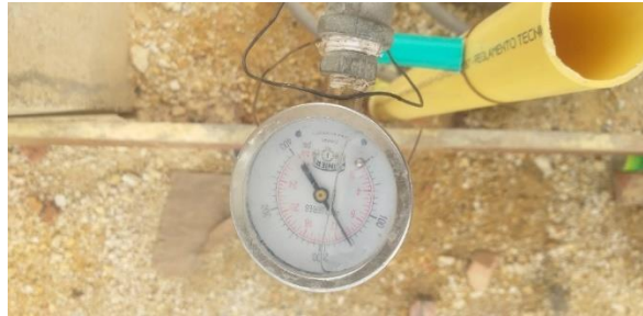
Figura 47.Registro de manómetro para verificar la presión del sistema
