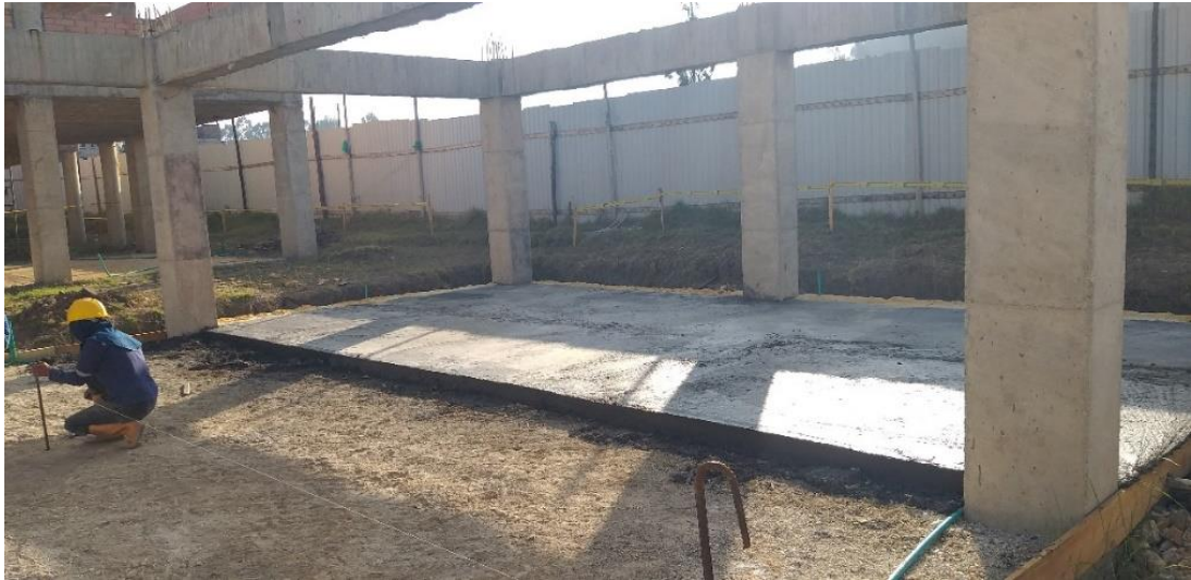
Figura 29. Vaciado de concreto de placa de contrapiso para los diferentes bloques de construcción
