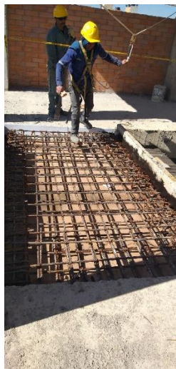
Figura 5 Amarre de acero para primera placa de conexión entre bloque E y F.
