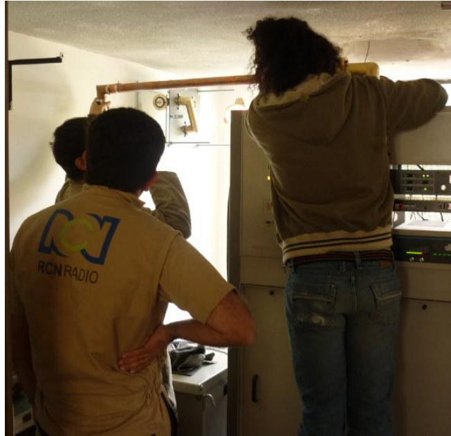
Figura 61. Línea de transmisión rígida para el transmisor principal.
