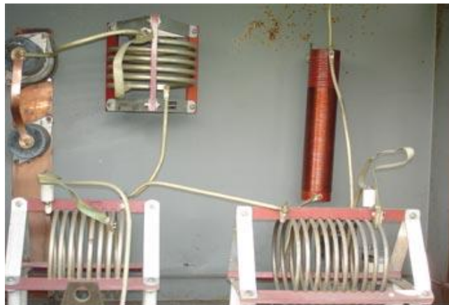
Figura 21. Caja de Sintonía ATU en estación radiodifusora de AM
