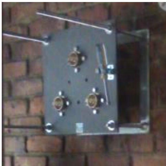
Figura 60. Switch cambiador de antena.
