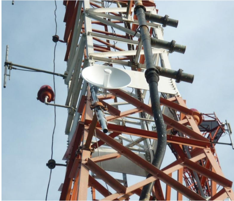
Figura 75B. Access Point en Transmisores Granadillo.
