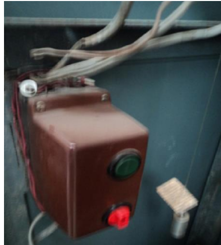
Figura 20 Arrancador y conexiones eléctricas Tomado de: Autor
