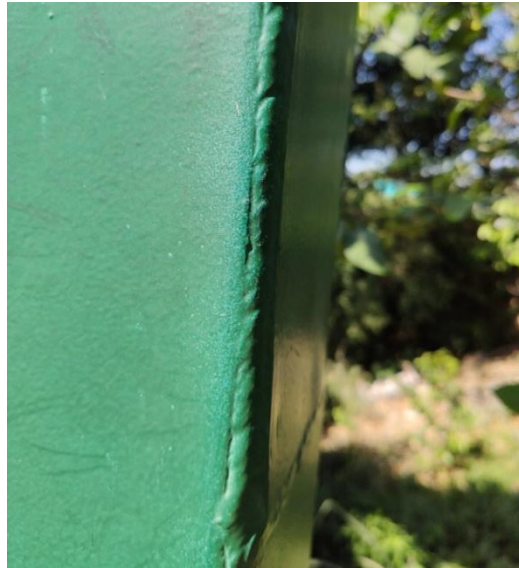
Figura 41 Fusión incompleta entre pases de soldadura Fuente: Propia
