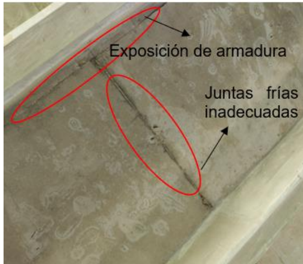
Figura 28 Deficiencia de construcción en losa Fuente: Propia
