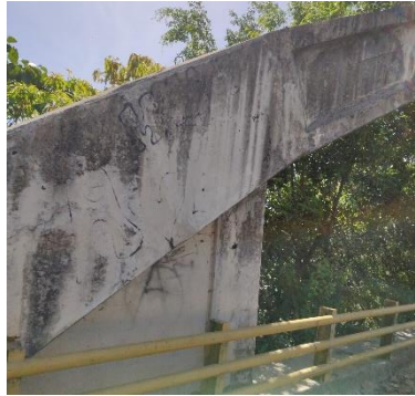
Figura 39 Concreto deteriorado Fuente: Propia
