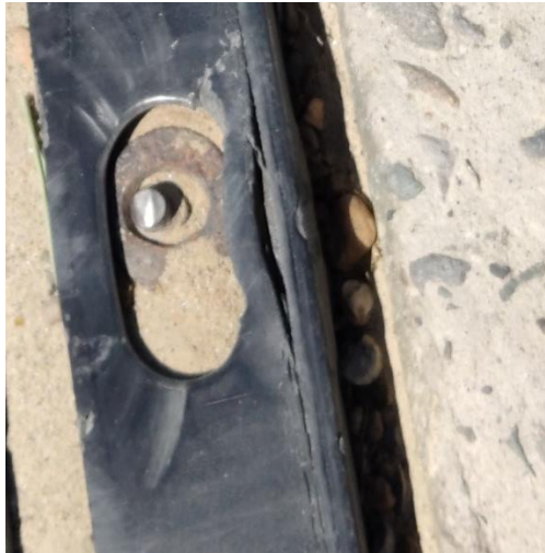
Figura 15 Daños tipo DGG, DPG, FIG en juntas de expansión Fuente: Propia
