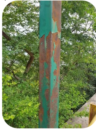
Figura 34 Deterioro en la pintura en elemento tipo Arco Fuente: Propia Arcos de Concreto
