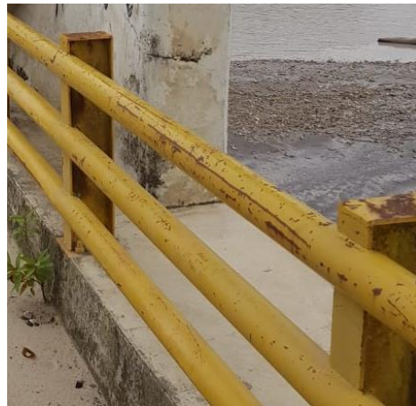
Figura 19 Oxidación en barandas Fuente: Propia
