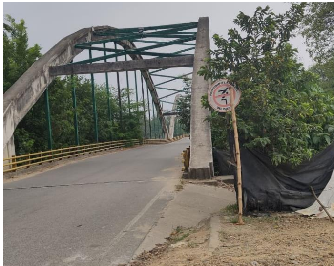
Figura 21 Falta de señalización Fuente: Propia
