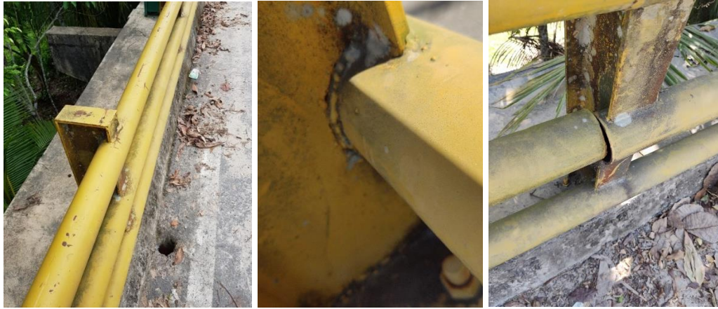
Figura 18 pintura en las barandas Fuente: Propia
