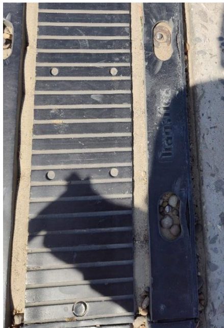
Figura 14 Daño tipo OB en juntas de expansión Fuente: Propia
