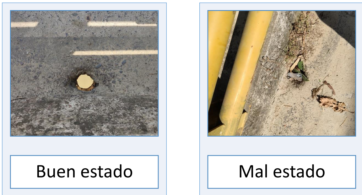
Figura 22 Estado del drenaje transversal Fuente: Propia
