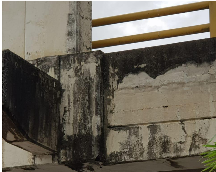
Figura 30 Humedad y deterioro del concreto Fuente: Propia
