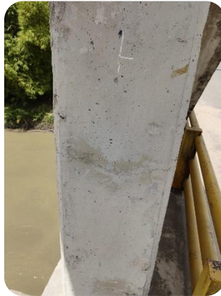
Figura 38 Filtración y eflorescencia Fuente: Propia
