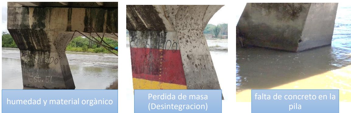
Figura 25 Patología en pilas Fuente: Propia
