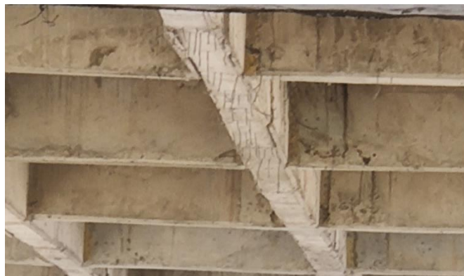
Figura 27 Corrosión en vigas y riostras Fuente: Propia
