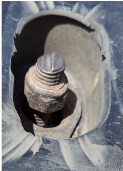
Figura 16 Daños tipo PD, PS en juntas de expansión Fuente: Propia
