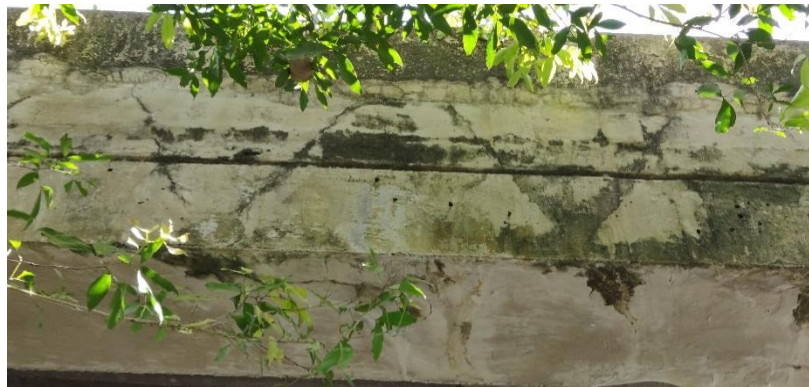
Figura 29 Fisuras por Torsión en vigas Fuente: Propia
