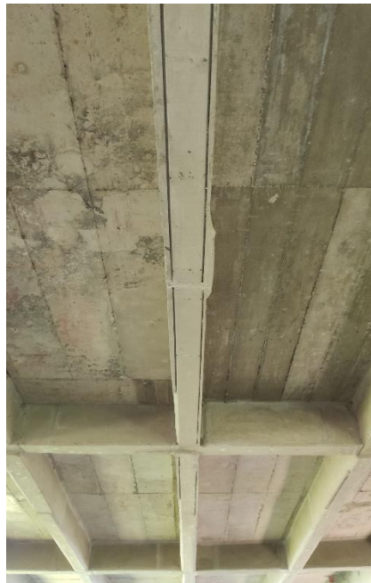
Figura 26 Falta de concreto de recubrimiento en losas, vigas y riostras Fuente: Propia
