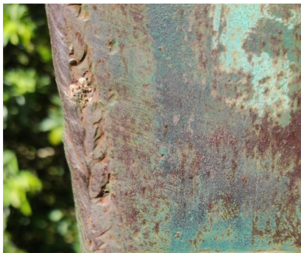
Figura 42 Fusión incompleta Fuente: Propia
