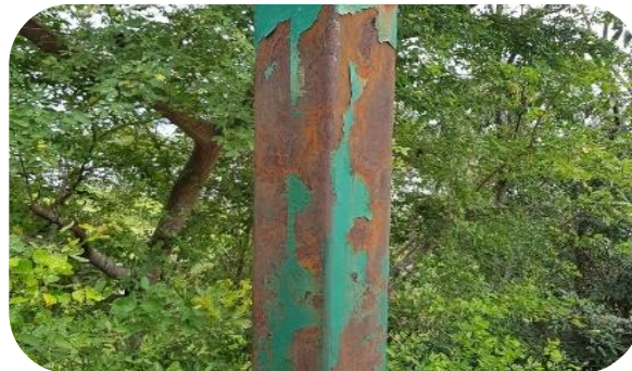
Figura 32 Corrosión y degradación en aceros en elemento tipo Arco Fuente: Propia
