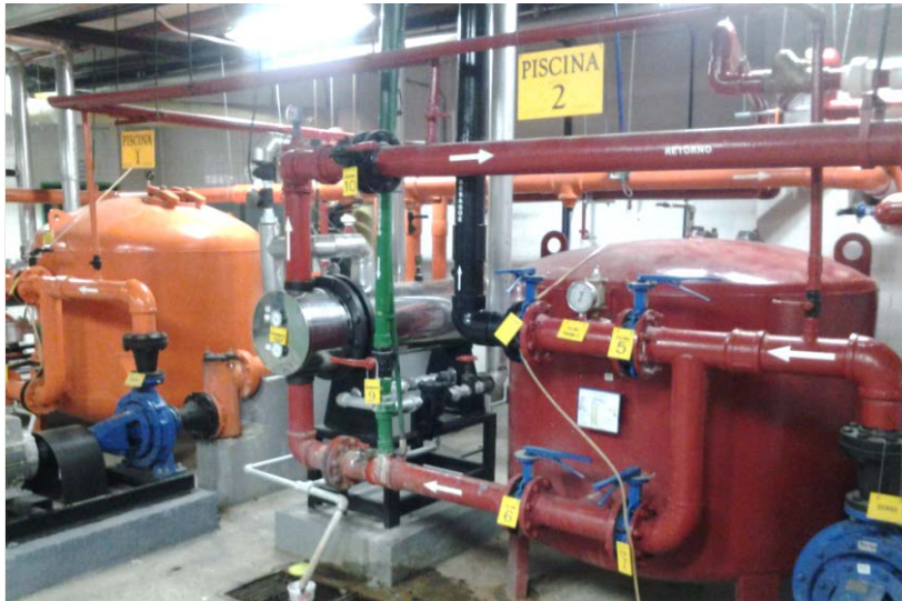
Ilustración 5: Sistema de tratamiento del agua de piscinas. Observable el equipo de tratamiento para la piscina 1 y 2. Cuenta con 4 filtros respectivamente. En la mitad el intercambiador de calor Fuente: Propia
