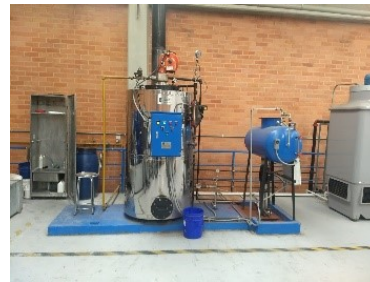
Caldera de gas
