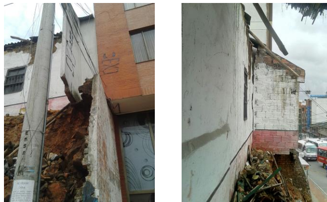
Imagen. 6 Muro en riesgo de colapso – Vista exterior.
