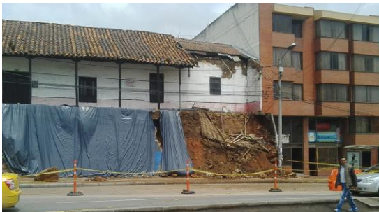
Imagen. 5 Casa colonial las nieves - Colapso
