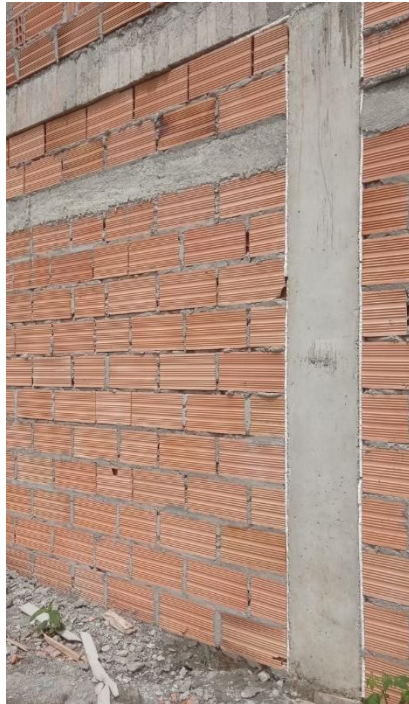
Figura 31. Fallos generados durante el proceso de ejecución de una mampostería confinada (dilatación de muro)
