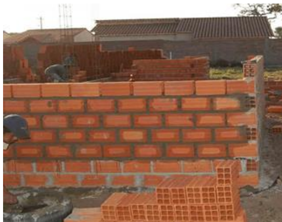
Figura 15. Fallos generados durante el proceso de ejecución de una mampostería confinada ( falta de hidratación )
