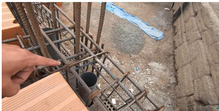
Figura 30. Fallos generados durante el proceso de ejecución de una mampostería confinada (debilitamiento del confinado)
