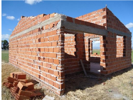
Figura 26. Fallos generados durante el proceso de ejecución de una mampostería confinada (deficiencia en los elementos de confinamiento por falta de revisión de planos de diseño)
