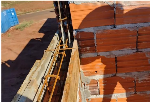
Figura 29. Fallos generados durante el proceso de ejecución de una mampostería confinada (malos procedimientos en el armado de vigas)
