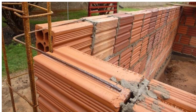
Figura 28. Fallos generados durante el proceso de ejecución de una mampostería confinada (viviendas adosadas)
