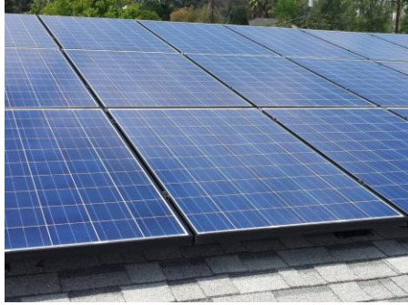
Figura 9. Paneles solar fotovoltaicos
