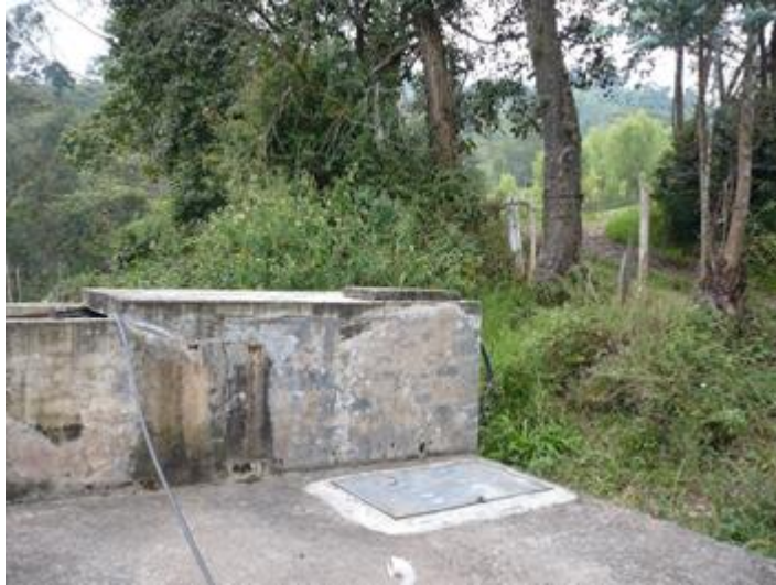
Fotografía 2: Tanque de almacenamiento
