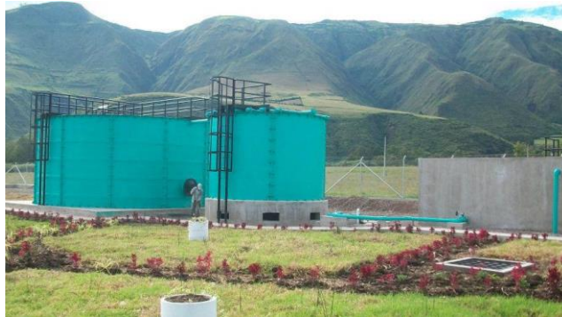
Fotografía 4: Planta de tratamiento de agua potable 6 LPS
