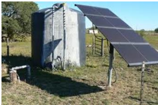
Fotografía 3: Bombeo de agua con energía solar fotovoltaica
