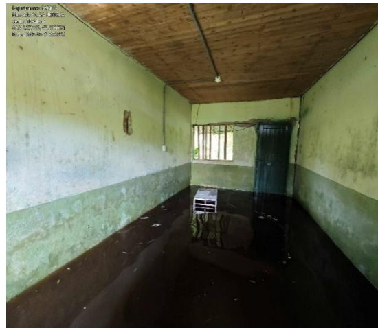
Imagen 11. Terreno inundado, no se realiza medición de sistema de puesta a tierra
