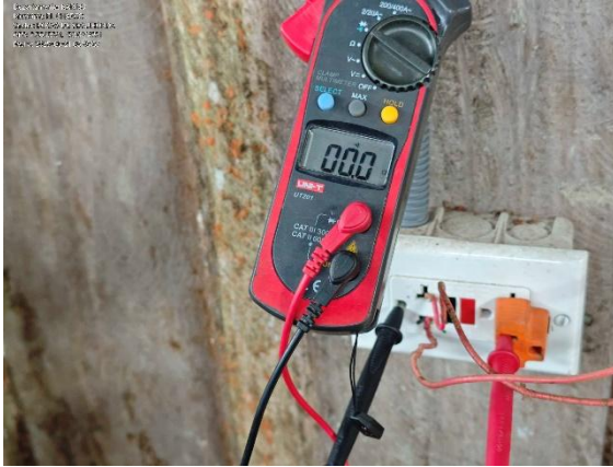
Imagen 8. Se observa la instalación de cables directos al tomacorriente por el usuario
