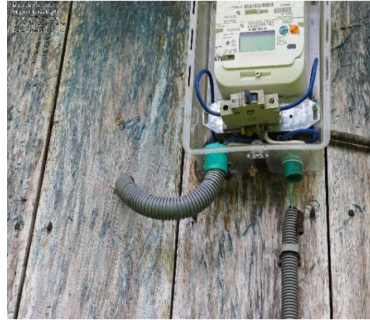
Imagen 17. Se observa la instalación prensaestopas en PVC en las salidas de línea de carga y spt, salida de spt se encuentra suelta.
