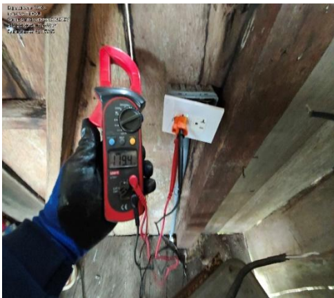
Imagen 14. Tomacorriente suelto porque la caja estaba partida donde va el tornillo de sujeción
