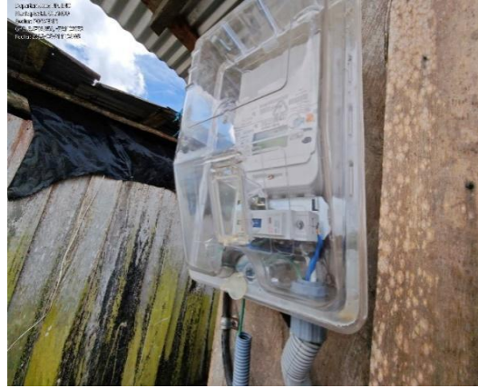
Imagen 9. No se instala prensaestopas a la salida de la tubería del SPT.
