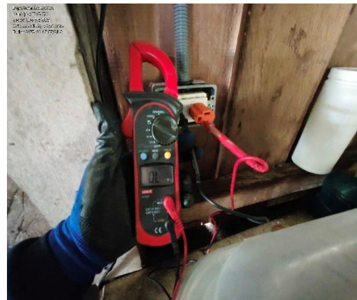
Imagen 15. Usuario informa que la tapa del tomacorriente se soltó y se perdió.
