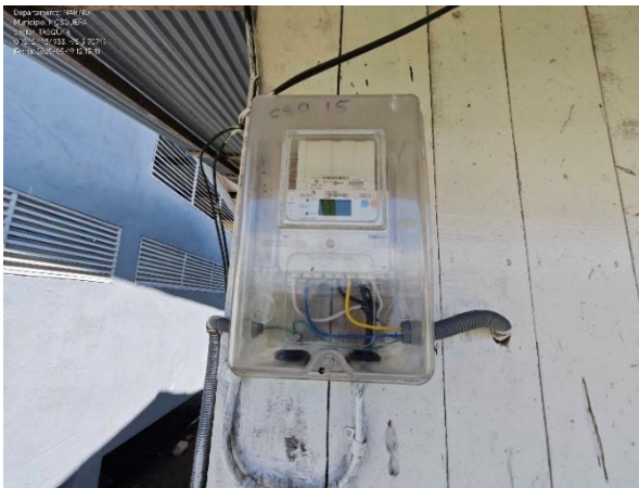
Imagen 10. Ausencia de breaker principal de 40a.
