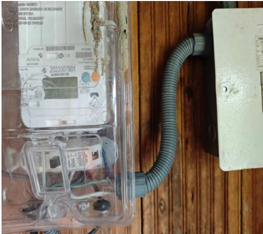
Imagen 12. Se instala breaker de 20amp en la salida del medidor, el autorizado era uno de 40amp.
