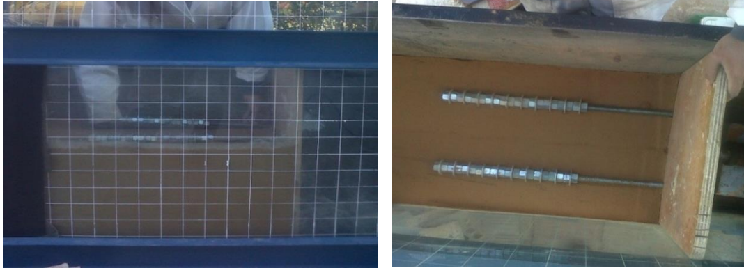
Foto 3-34 Ubicación de los anclajes
