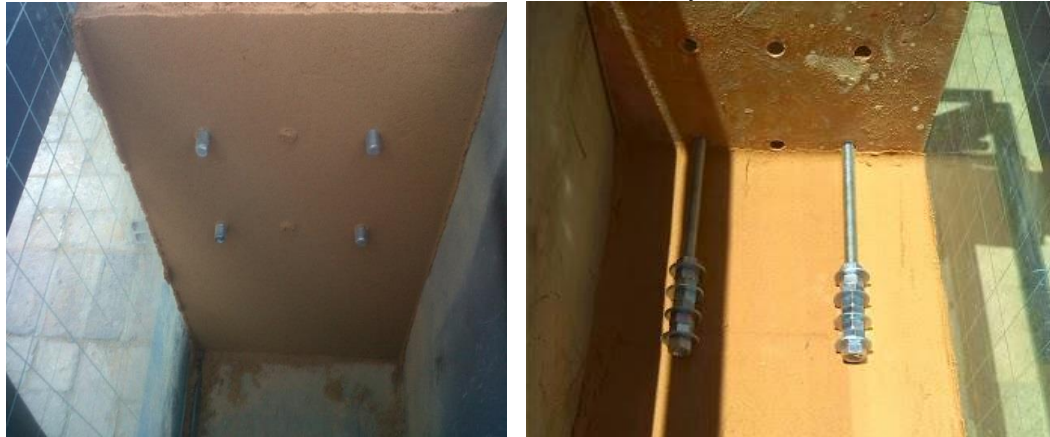
Foto 3-25 Ubicación de los anclajes
