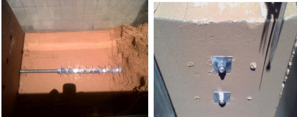
Foto 3-31 Ubicación de los anclajes
