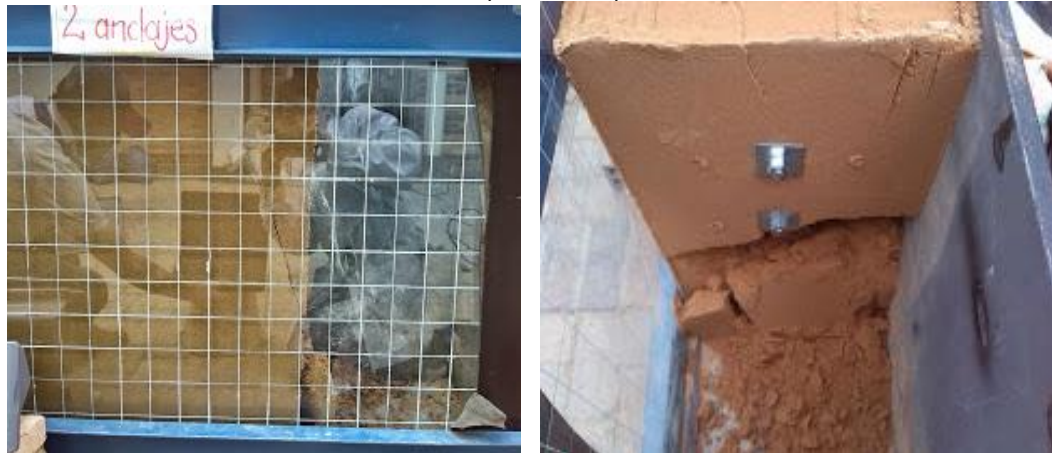
Foto 4-2 Falla presentada por el talud
