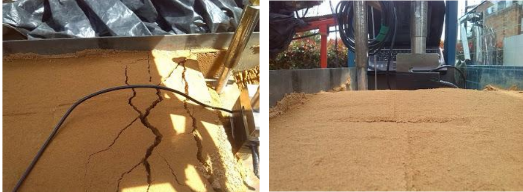
Foto 4-12 falla por encima del talud
