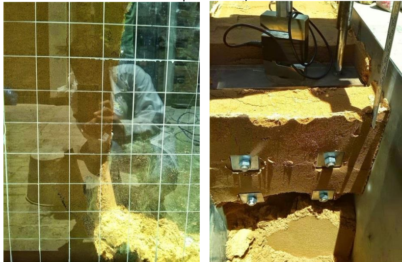
Foto 4-3 Falla presentada por el talud
