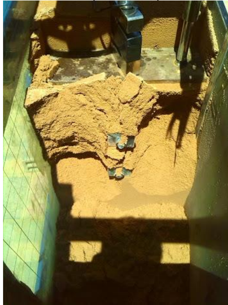
Foto 4-6 falla presentada por el talud
