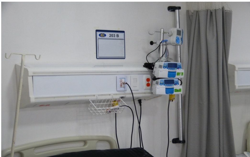
Figura 40. Consola Cabecera multiservicios existente en la clínica.
