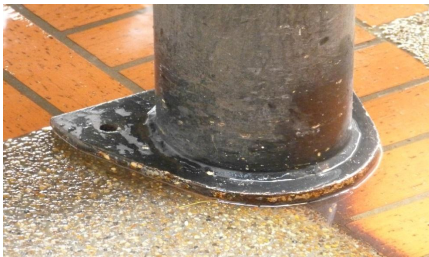
Figura 22. Zonas de equipo gases medicinales tanque de oxígeno-soporte de anclaje.
