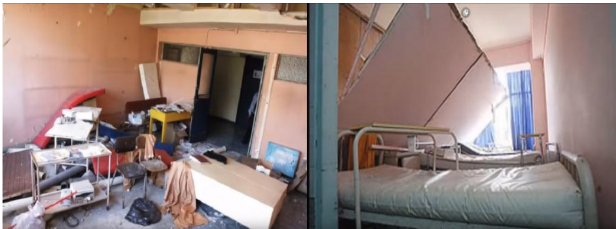
Figura 8. Zonas del Hospital Félix Bulnes destruidas por el terremoto. Tomado de: Organización Panamericana de la Salud (2010).
