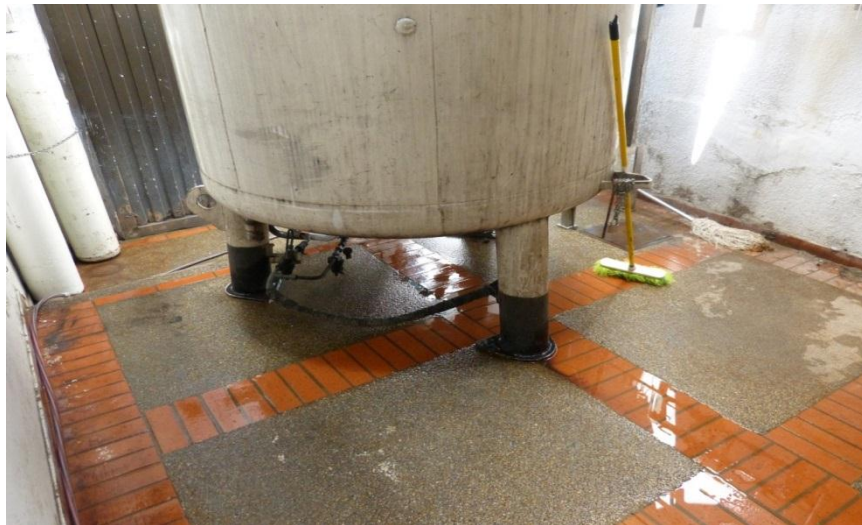
Figura 21. Zonas de equipo gases medicinales tanque de oxígeno.
