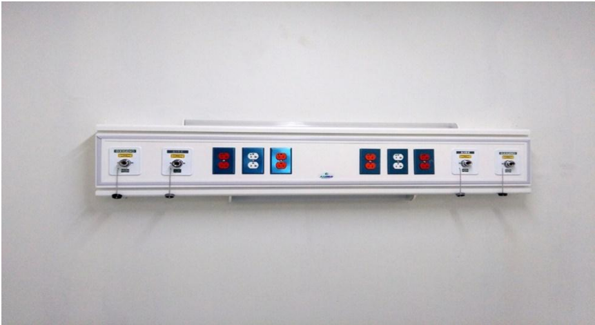
Figura 41. Consola Cabecera multiservicios existente en la clínica
