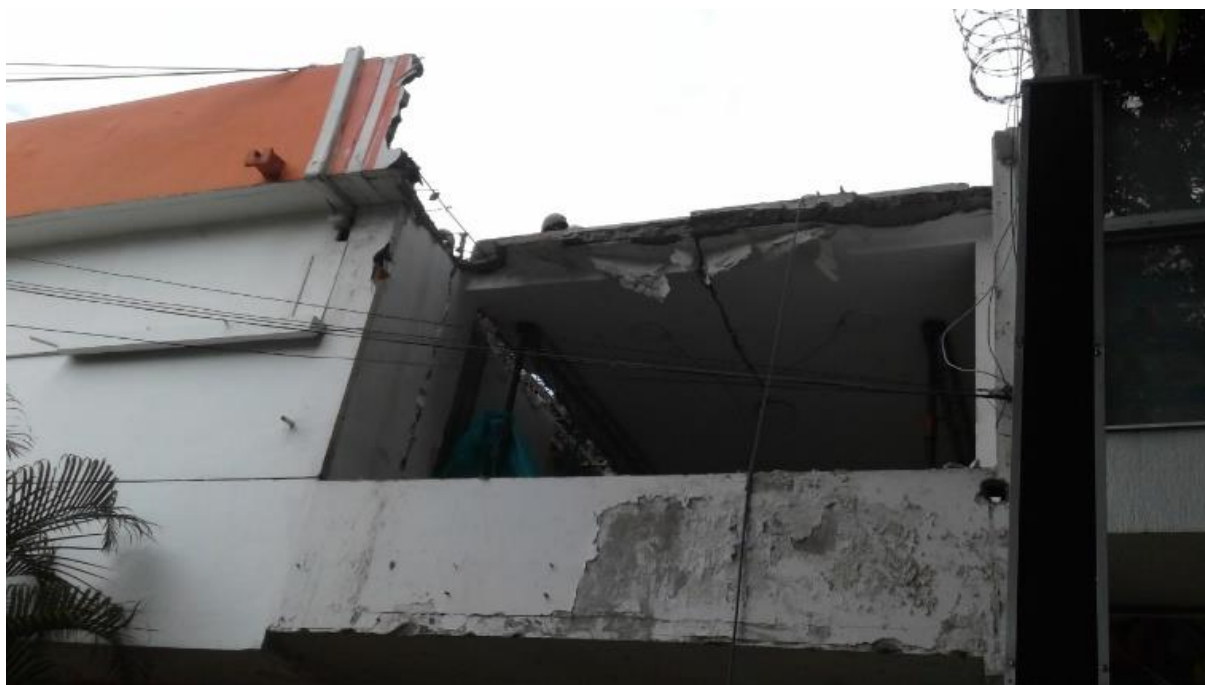
Figura 5. Detalle viga canal fallada sede 2 de Oftalmolaser
