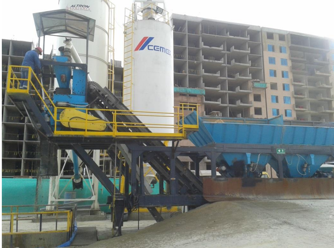
Fotografía 2. Planta concretera HORMIGÓN URBANO S.A.S
