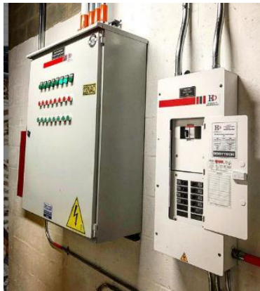
Figura 19 Uso de etiquetado en subestaciones de Energía y Diseños S.A.S.
