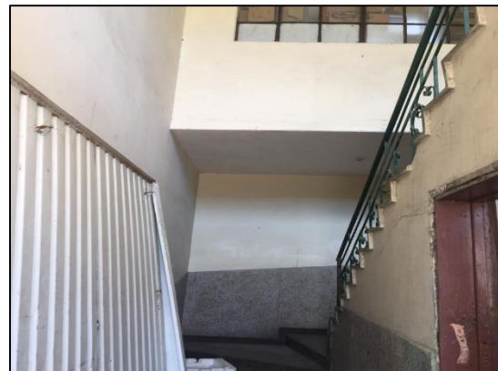
Ilustración 39 Accesos escaleras reducidos y sin descanso
