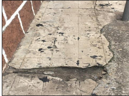
Ilustración 46 Daños en andén vista 2
