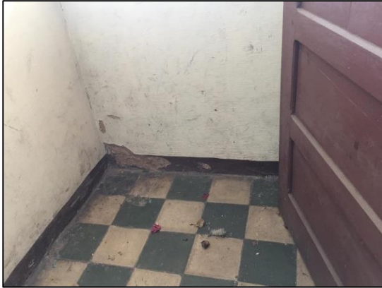
Ilustración 40 Desprendimientos en paredes
