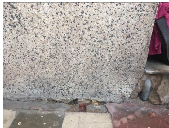
Ilustración 32 Desprendimiento placa columna
