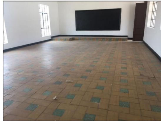
Ilustración 55 Fisuras en algunas baldosas salón
