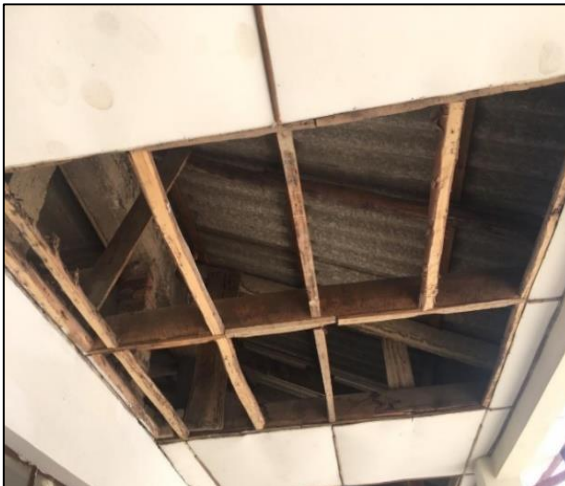
Ilustración 58 Afectaciones en entramado – vista 1
