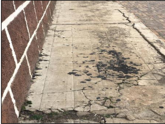
Ilustración 45 Daños en andén vista 1
