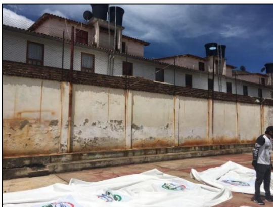
Ilustración 56 Afectaciones en muros patio – vista 1
