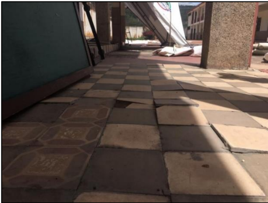
Ilustración 54 Desprendimiento y rotura de baldosas hall patio
