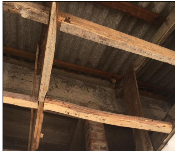
Ilustración 59 Afectaciones en entramado – vista 2
