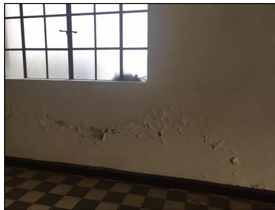
Ilustración 42 humedad en paredes internas
