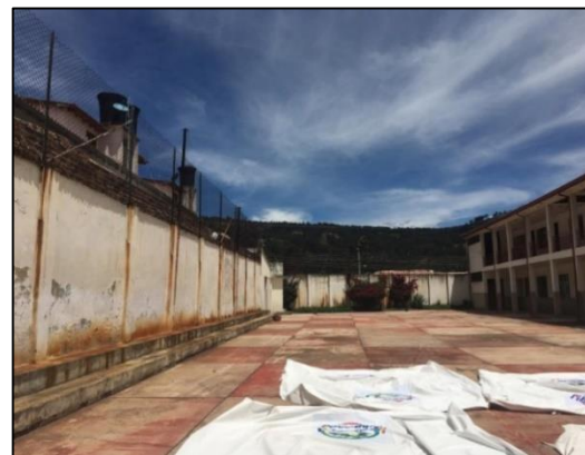
Ilustración 57 Afectaciones en muros patio – vista 2
