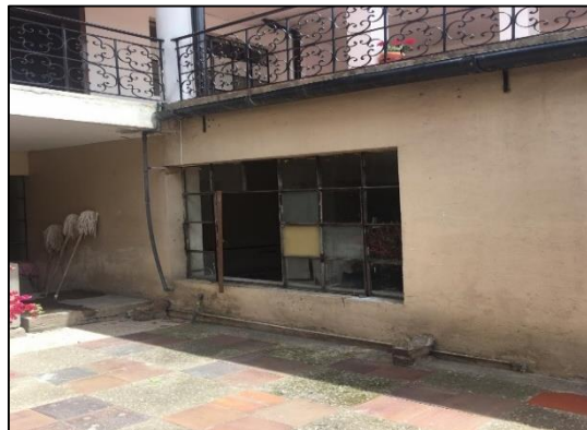
Ilustración 60 Afectaciones en placa y muro, por humedad
