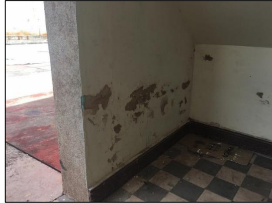
Ilustración 41 Estado de paredes internas
