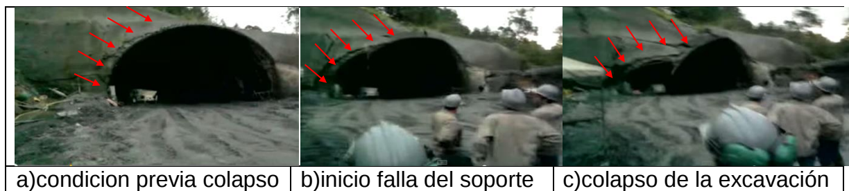
Figura 40 Colapso túnel de ladera Colombia 10-01-2012 modificado www.eltiempo.com.
