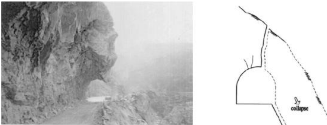
Figura 57 Inestabilidad de la ladera detonante de la falla del túnel (Wang 2001)
