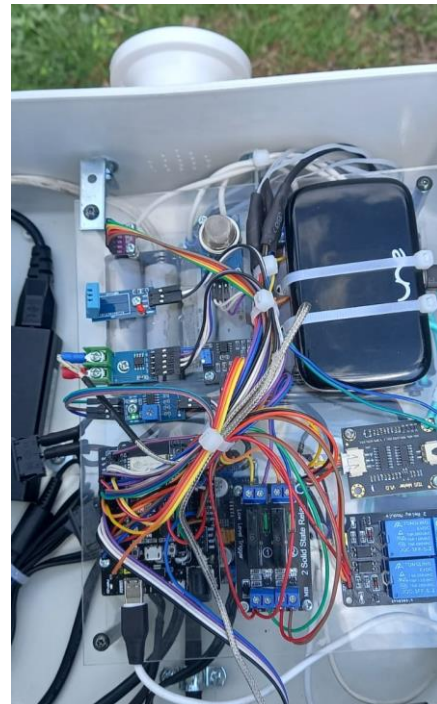
Ilustración 36. Sistema completo de electrónica y potencia, con espacios de ventilación.
