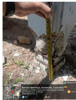
Foto 3. Columna de concreto afectada.
