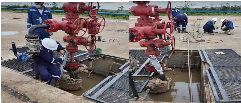
Figura 16: Conexión o empalme de cable centrífugo con cable de bomba eléctrica en cabeza de pozo listo para pruebas y arranque de pozo
