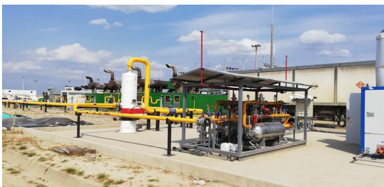
Figura 10: Puesta en marcha generadores eléctricos alimentados por gas filtrado y controlado desde scrubber en tigrana.
