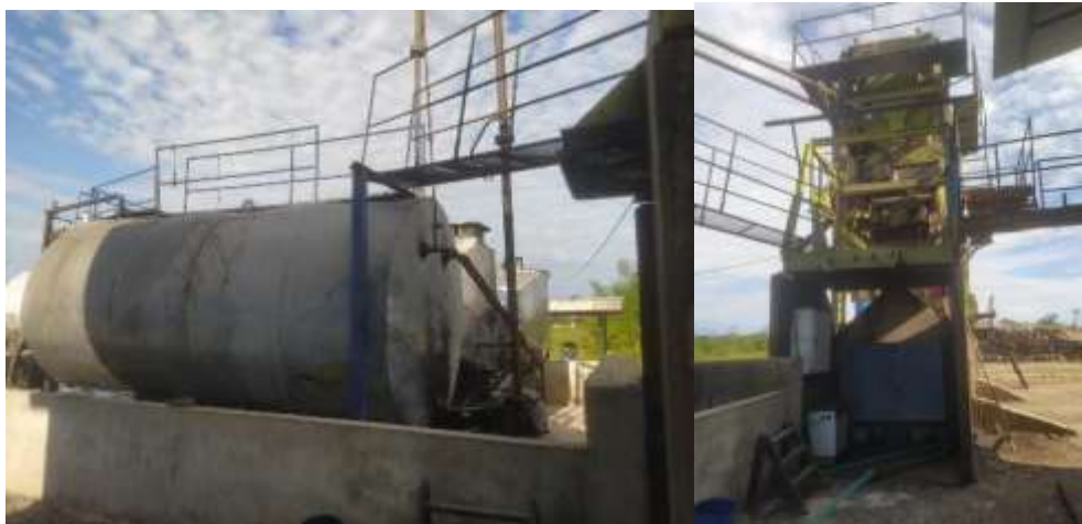
Figura 2. Planta de asfalto PASOLIN
