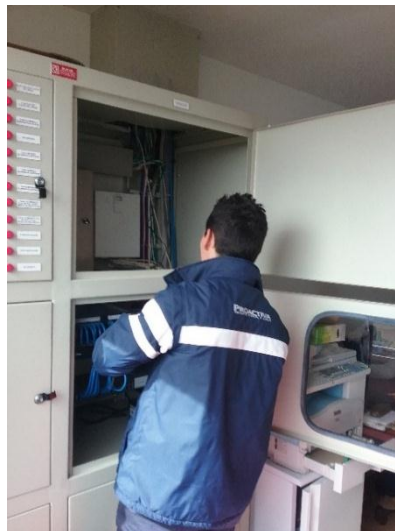
Figura 146. Funcionario realizando la conexión de la red wifi.
