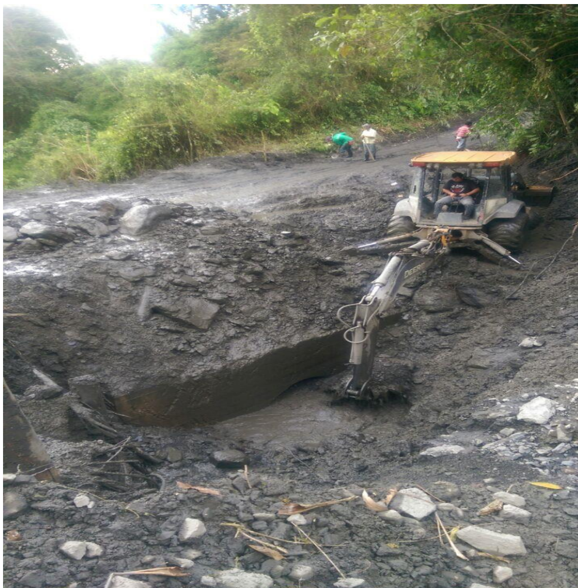
Fotografía 37 Taponamiento del box culvert por arrastre de material
