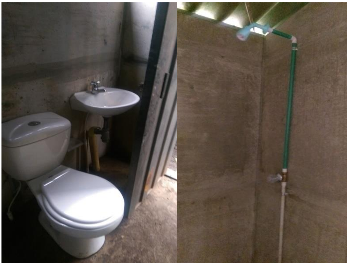
Fotografía 9 Instalaciones de lavamanos, sanitario y ducha
