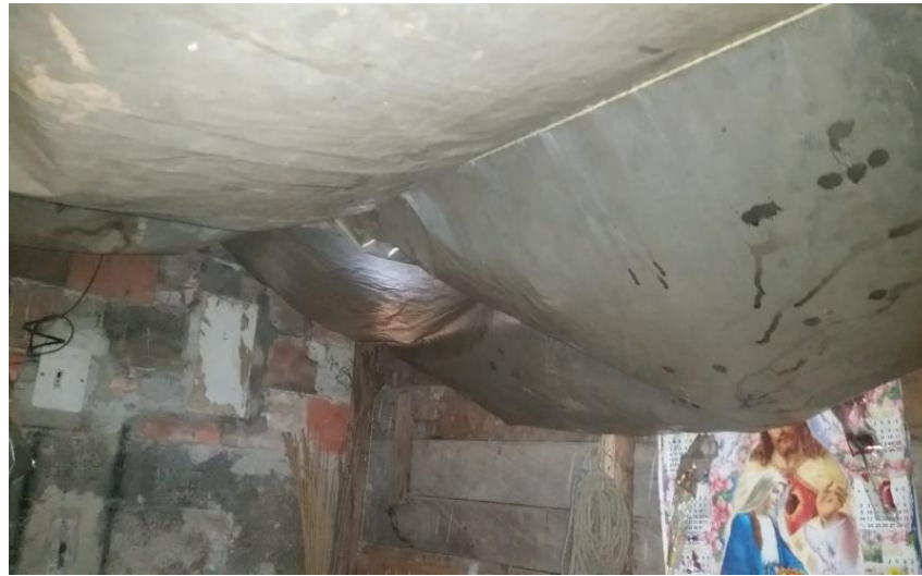
Fotografía 29 Estado de la vivienda
