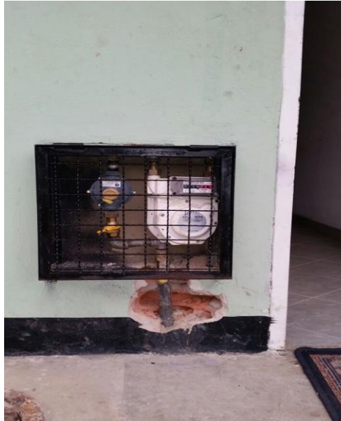
Fotografía 12 Contador de gas con el tubo de entrada al descubierto
