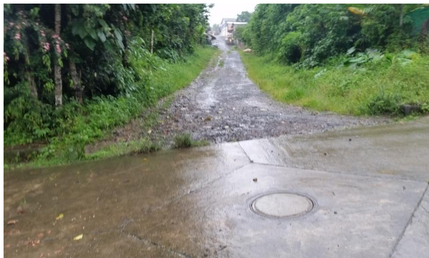
Fotografía 23 Calle 4, sin pavimentar
