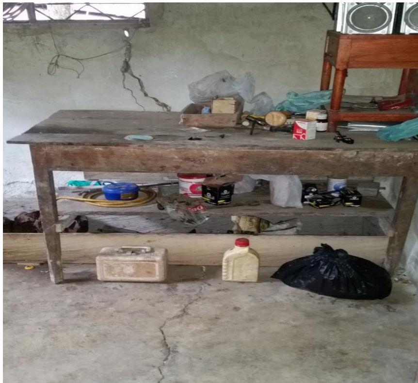
Fotografía 22 Grietas vivienda Miguel Cubides
