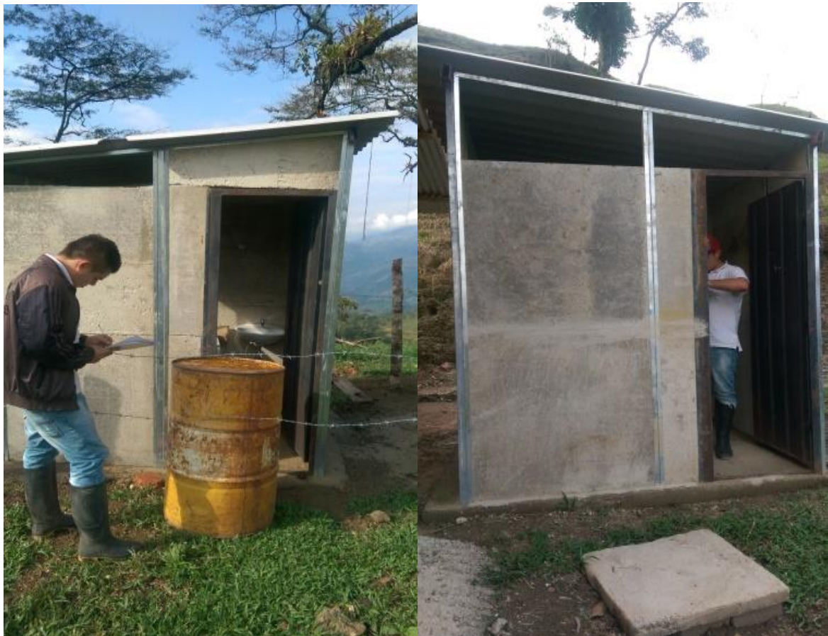
Fotografía 8 Caseta sanitaria con plaquetas faltantes
