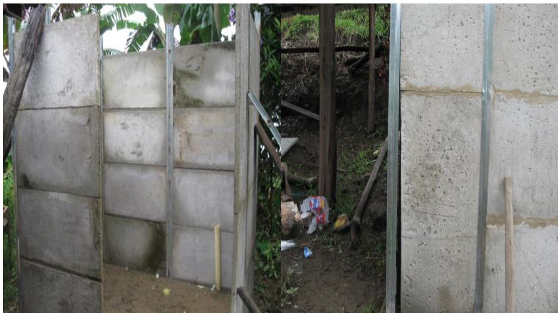
Fotografía 33 Casetas sanitarias con imperfectos e inconclusas
