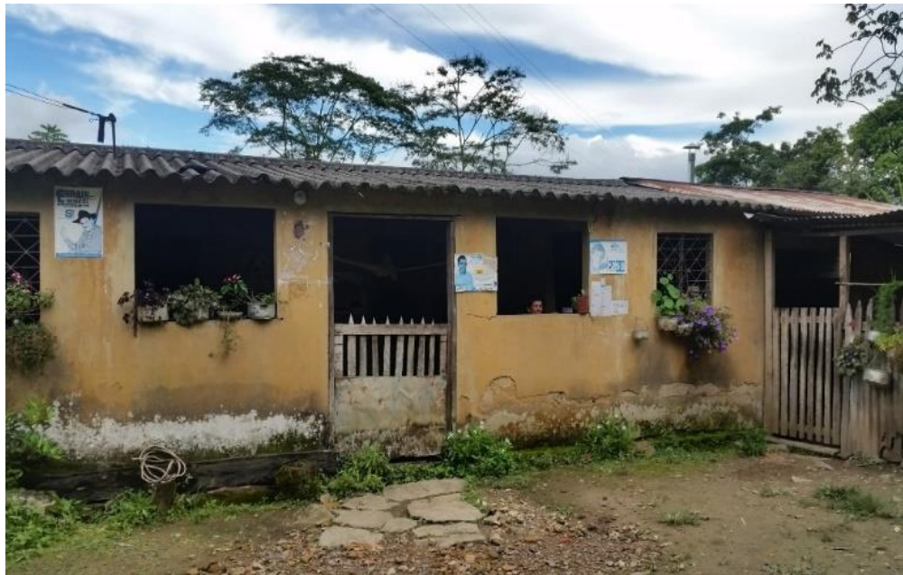
Fotografía 21 Residencia con afectación estructural
