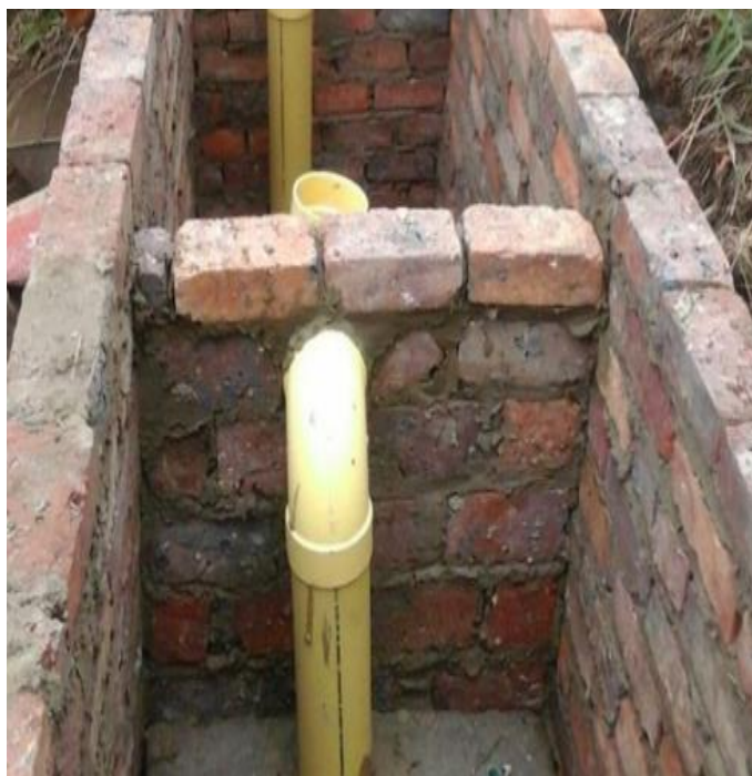
Fotografía 14 Tanque séptico y trampa de grasas
