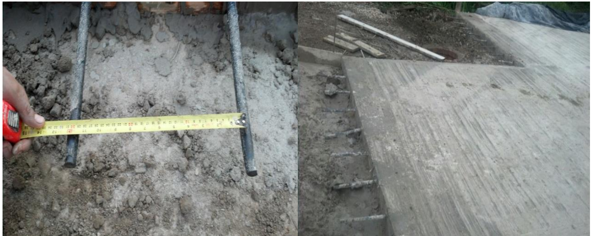
Fotografía 3 Espaciamiento entre refuerzo pavimento
