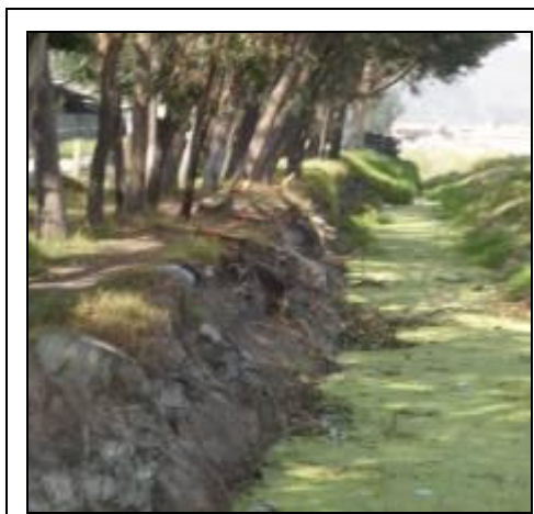
Foto 7.3-3. El estado de colmatación de los vallados y el Canal Canoas por macrofitas y residuos sólidos, impiden el normal ingreso de agua al humedal de Tierra Blanca.
