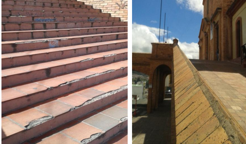
Fig.26 Detalle estado de escaleras y vista de rampa (Fuente: Autores)
