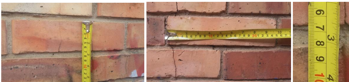
Fig.30 Dimensionamiento y Estado de descascaramiento del ladrillo. (Fuente: Autores)
