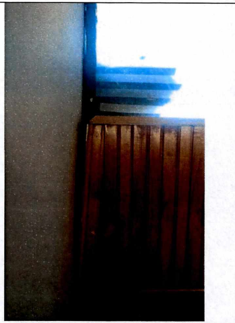
Fotografía 22. Dilatación visible en el altillo del tercer piso – 04 de febrero de 2019
