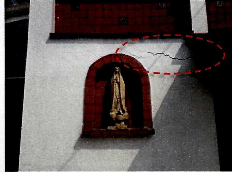
Fotografía 10. Grieta sobre el muro perimetral del costado occidental – fachada principal del predio.
