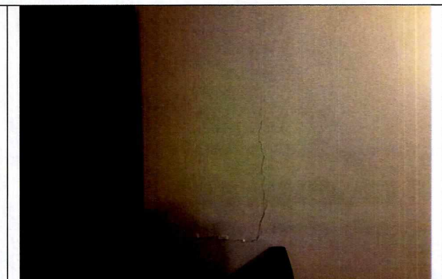
Fotografía 20. Grietas en muro interior de closet – habitación auxiliar del segundo piso – 04 de febrero de 2019
