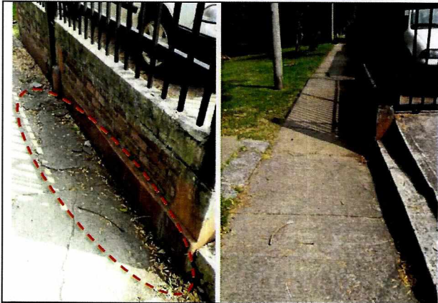
Fotografía 5. Hundimientos locales del sendero peatonal – Calle 117B con Carrera 71F
