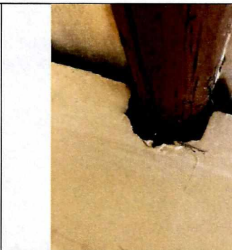
Fotografía 24. leve desprendimiento de vigas de madera en habitación del costado oriental del primer piso
