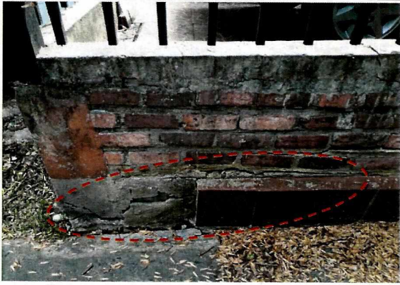
Fotografía 6. Fisuras en la base del muro de cerramiento del antejardín del predio de la Carrera 71F No. 116A – 96.
