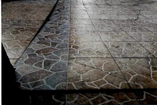
Fotografía 9. Afectaciones en las baldosas de enchape – área del parqueadero del predio evaluado.
