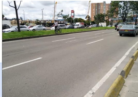
Ilustración 18. Estado de la vía. Av. Boyacá – Calle 80
