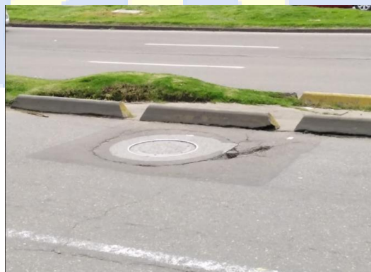
Ilustración 17. Estado de la vía. Av. Boyacá – Calle 80
