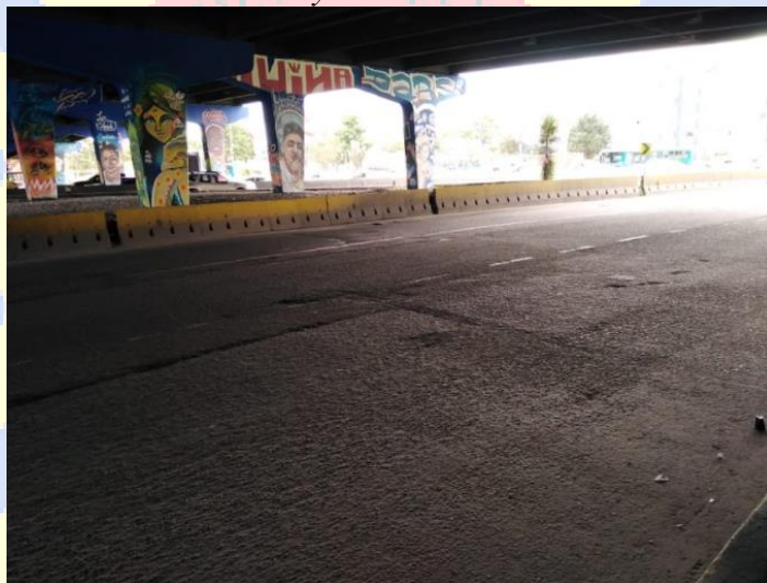
Ilustración 19. Estado de la vía. Av. Boyacá – Calle 80
