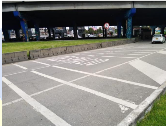
Ilustración 20. Señal horizontal. Av. Boyacá – Calle 80
