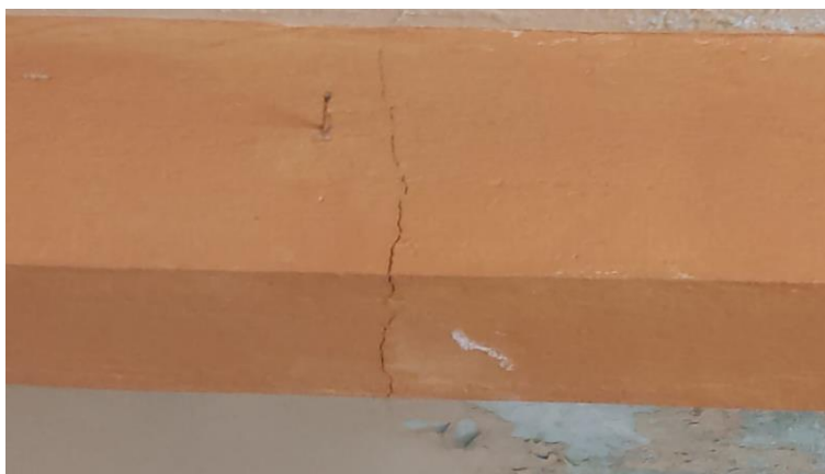
Figura. 6 Fisura viga de carga
