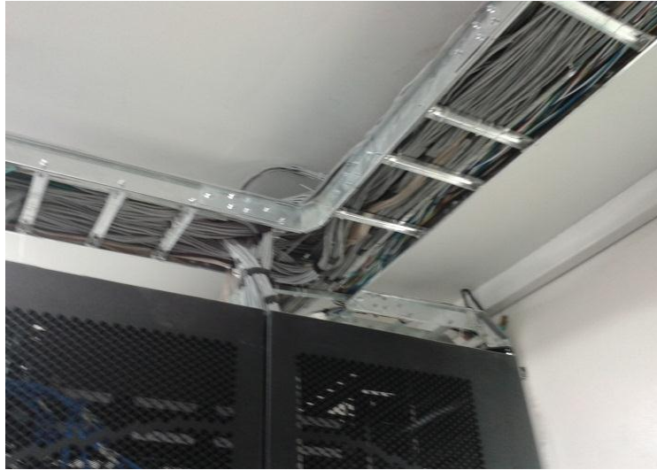
Imagen 6. Cableado tendido al rack de centralización. Fuente: Autor
