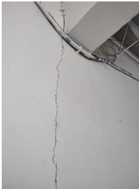
Imagen 23 Grita de junta de construcción, Fuente: Propia
