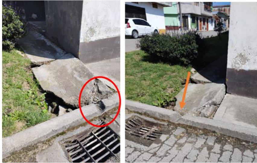
Imagen 17 Desprendimiento y hundimiento de placa de concertó, Fuente: Propia
