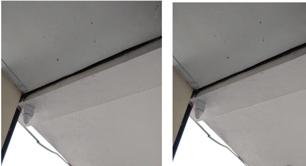
Imagen 22 Separaciones de losa en los bloques, Fuente: Propia
