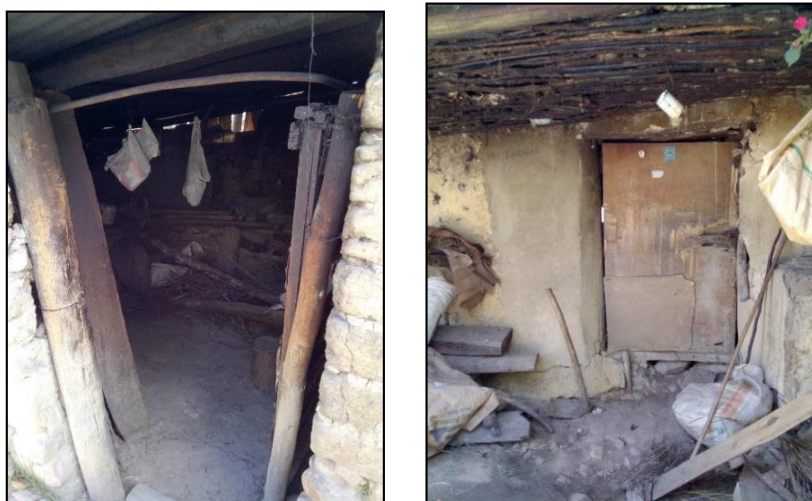
Ilustración 14: Vivienda afectada en la Vereda El Bosque.
