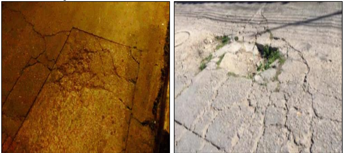
Ilustración 15: Patologías encontradas en la calle del Amor.
