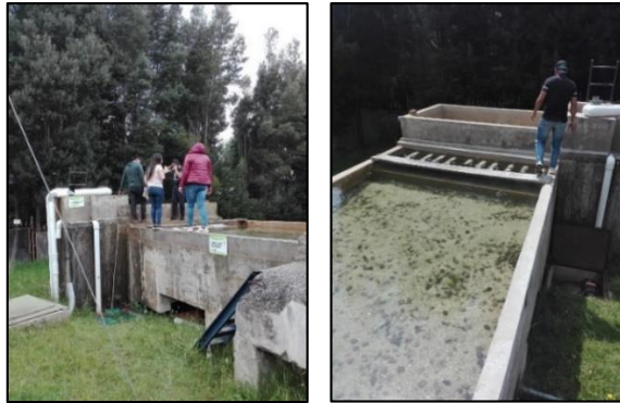
Ilustración 20: Módulo de la PTAP- Sedimentador
