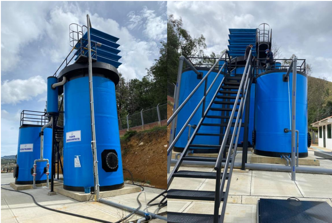
Imagen 10: Planta de Tratamiento moducompacta
