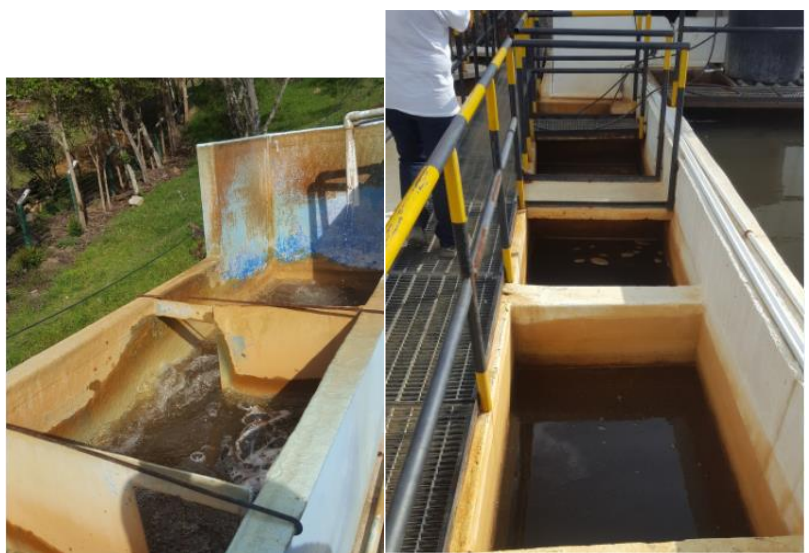
Imagen 9: Procesos realizados en la Planta de Tratamiento de Agua Potable.
