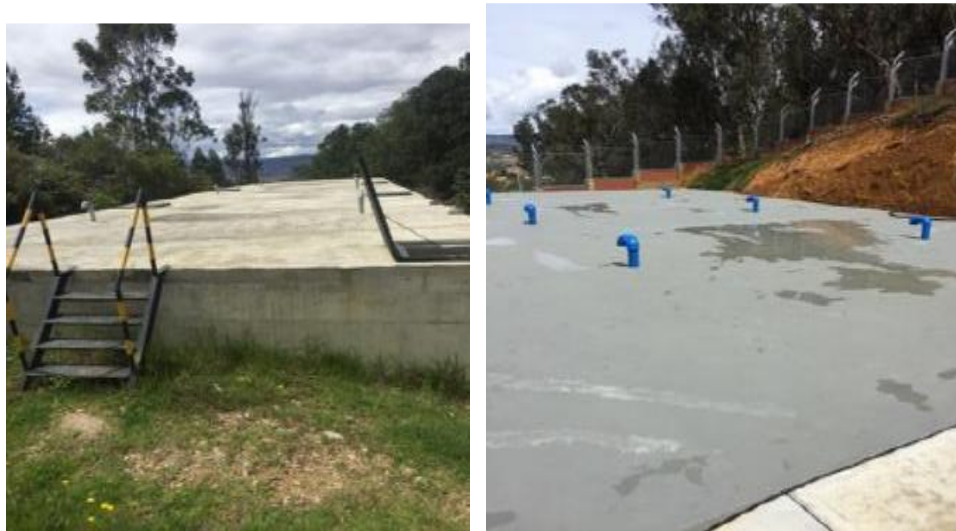
Imagen 11: Tanques de almacenamiento de agua potable
