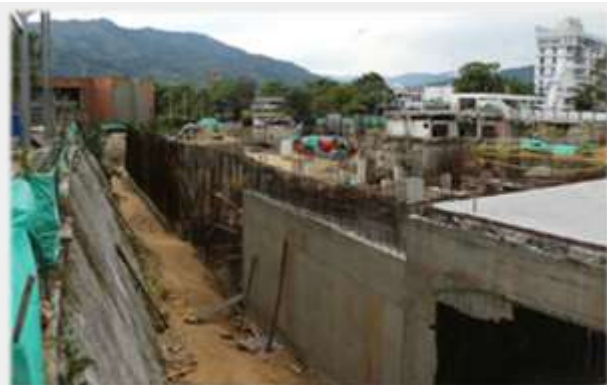
Escenario (Unidad Deportiva calle 42): Edificio Artes Marciales. Valor pagado: $7.413.886.972. Porcentaje de avance: 28.5%*
