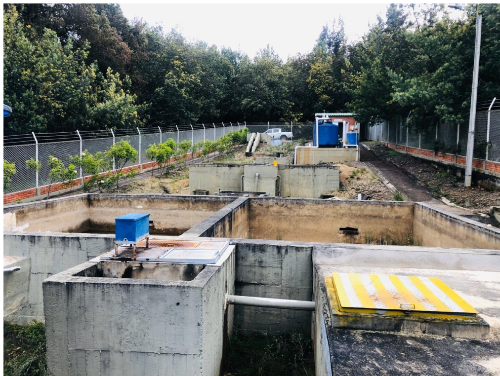
Fotografía 25. Planta de tratamiento de agua potable. Municipio de Saboyá
