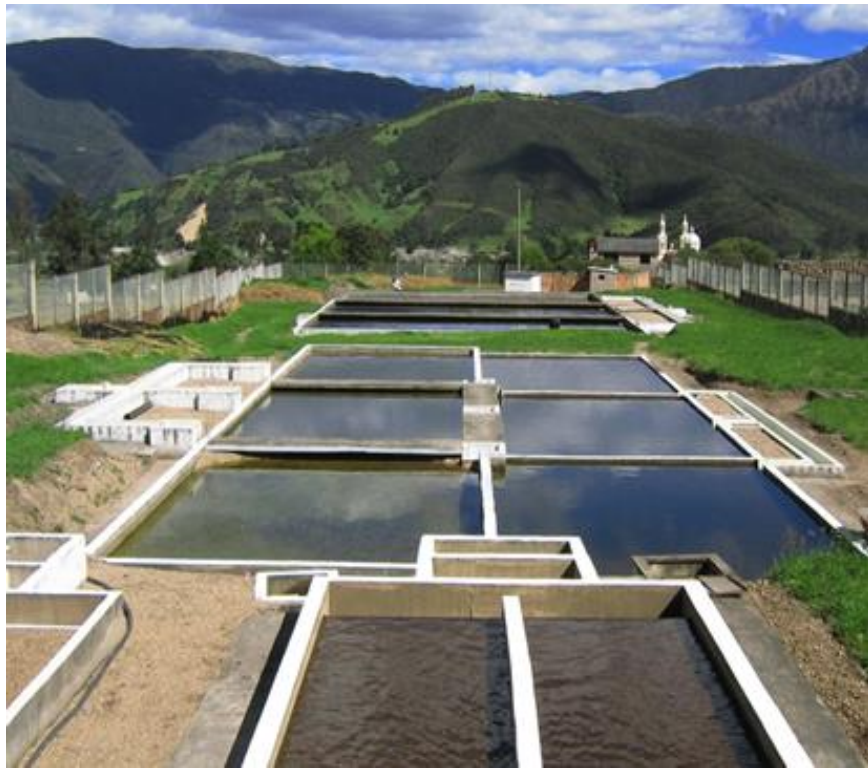
Fotografía 22. Planta de tratamiento de agua potable. Municipio de Belén
