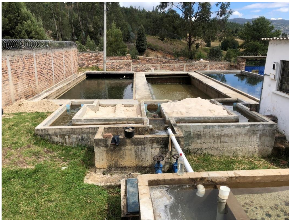
Fotografía 21. Planta de tratamiento de agua potable. Municipio de Firavitoba
