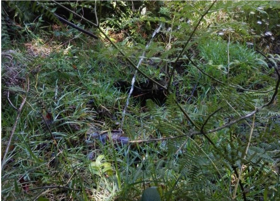
Fotografía 14. Fugas en la línea de aducción. Municipio de Sotaquirá
