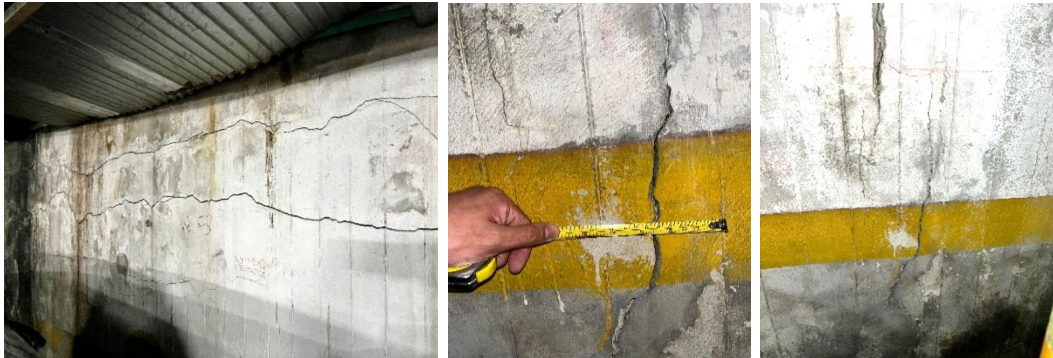
Figura 18: Afectaciones muros de contención.
