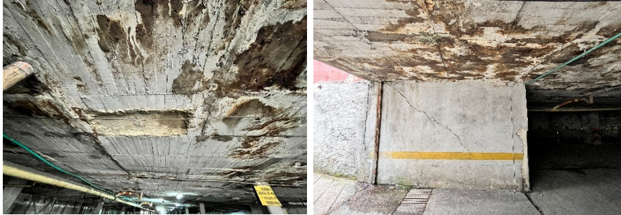
Figura 17: Humedad placa superior
