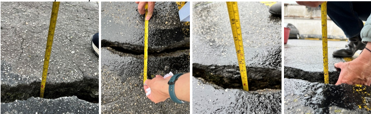
Figura 16: Fracturas en placa superior
