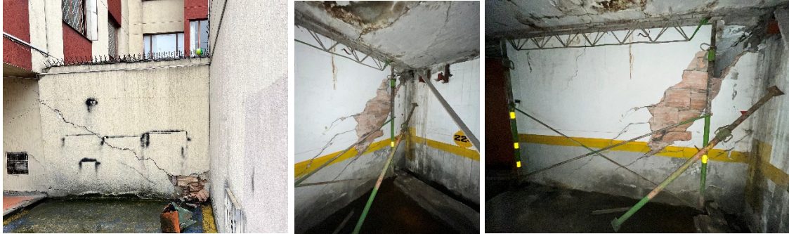
Figura 20: Afectaciones muros no estructurales.
