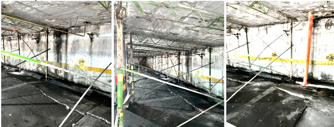
Figura 19: Fractura placa inferior
