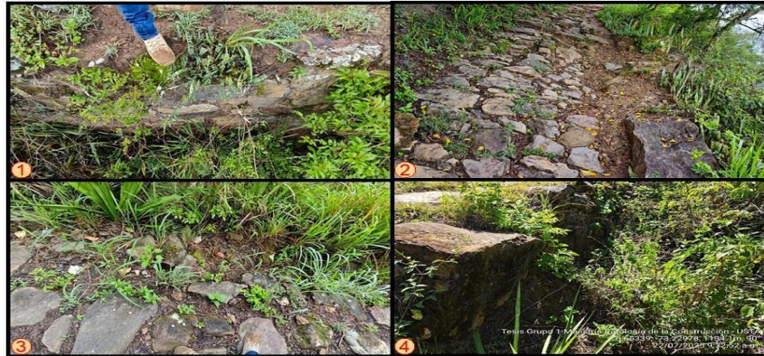
Figura 14. Pérdida parcial por elementos de contención de la calzada
