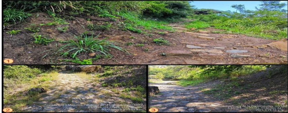
Figura 12. Pérdida de soporte y des confinamiento de la estructura del Camino
