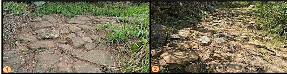
1. Pérdida de soporte y confinamiento Tramo 1. 2. Pérdida de soporte y confinamiento en el tramo 3. Fuente: Elaboración Propia
