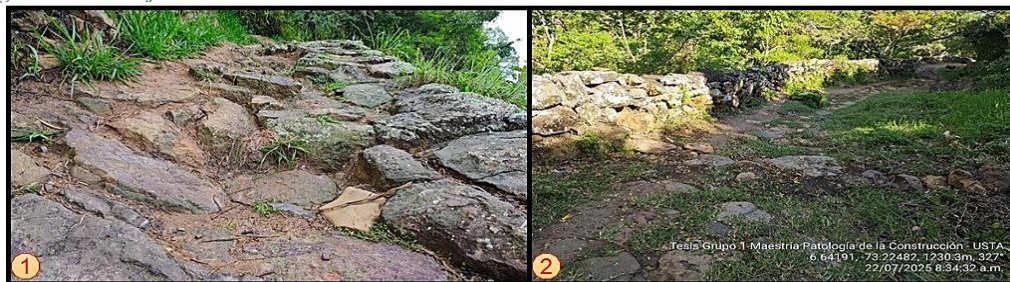
1. Drenaje inadecuado registrado en el tramo 1. 2. Drenaje inadecuado registrado en el tramo 2.
