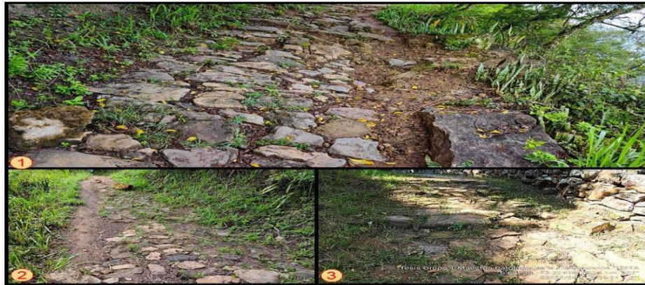
Imagen 1. Alteración de la sección de la calzada por des configuración en tramo 1. Imágenes 2 y 3. Alteración en la sección típica del camino por des configuración tramo 2 y 3. Fuente: Elaboración Propia
