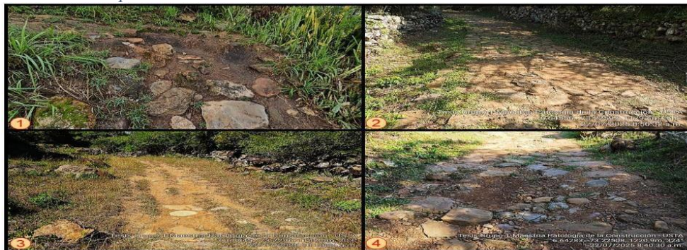
Figura 17. Pérdida parcial de material rocoso
