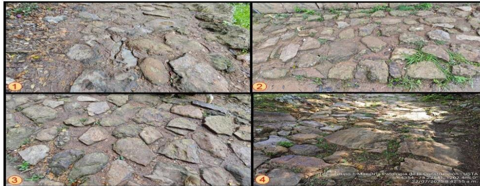
1 y 2. Técnica registrada en el tramo 1. 3. Técnica registrada en el tramo 2. 4. Técnica incorrecta registrada en el tramo 3. Todas las anteriores durante intervención del año 1998. Fuente: Elaboración Propia
