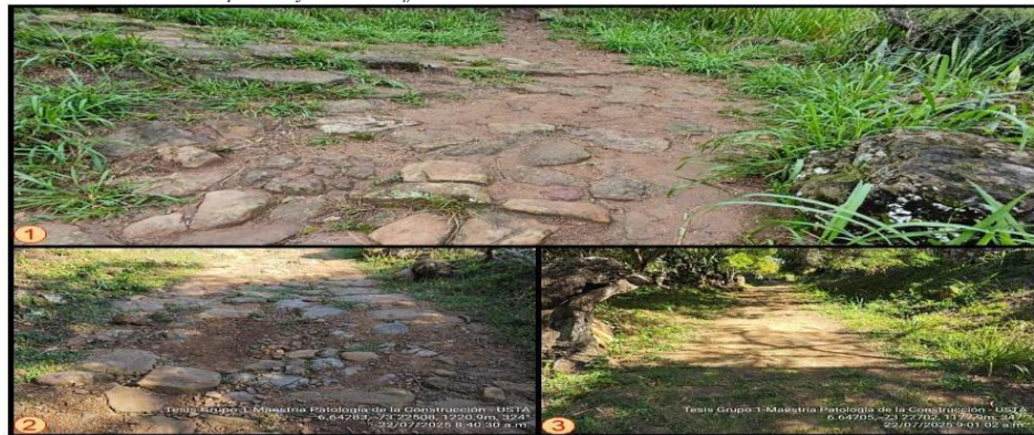
Imagen 1. Depósitos por material de arrastre en el tramo 1. Imagen 2. Material depositado por arrastre registrado en el tramo 2. Imagen 3. Depósitos por material de arrastre en el tramo 3. Fuente: Elaboración Propia
