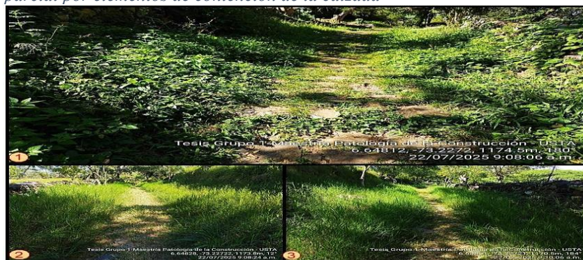
Figura 15. Pérdida parcial por elementos de contención de la calzada
