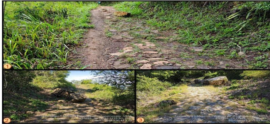
Figura 13. Desprendimiento de rocas y bloques de coluvión
