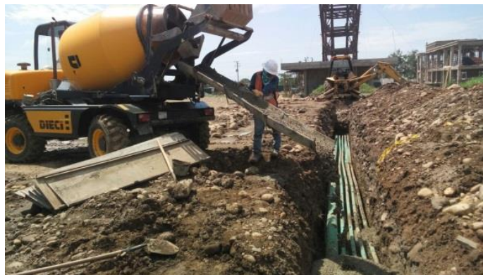
Fotografía 51. Acometida principal banco ducto de media tensión
