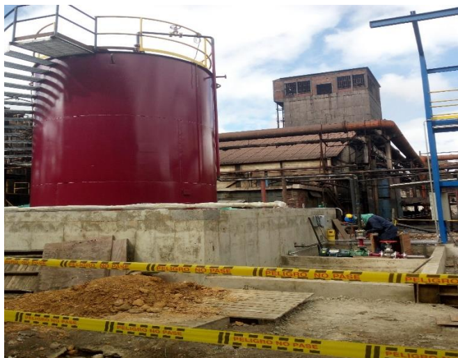
Fotografía 7. Tanque de almacenamiento
