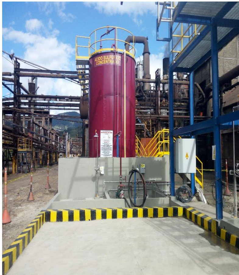
Fotografía 15. Nuevo tanque de almacenamiento de ácido sulfúrico
