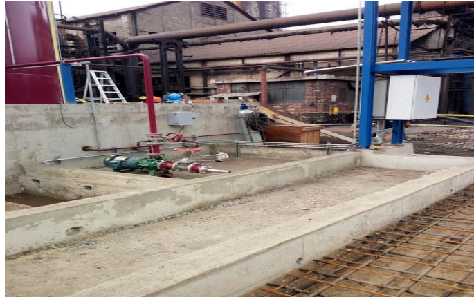
Fotografía 6. Bombas de descargue y de dosificación
