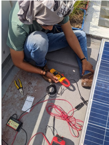
Figura 39. Verificación de corriente entregada por el panel
