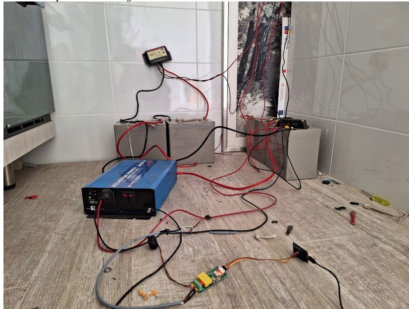
Figura 40. Conexión de prueba a infraestructura del laboratorio
