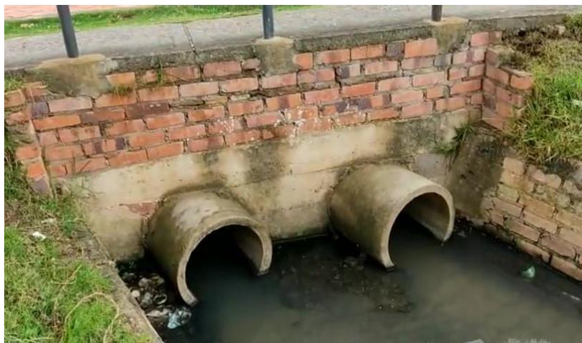
Figura 14: saliente de tubería en el cruce Intersección Canal las Quintas.
