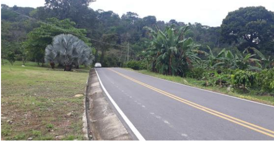
Estado de la vía principal acceso al lote
