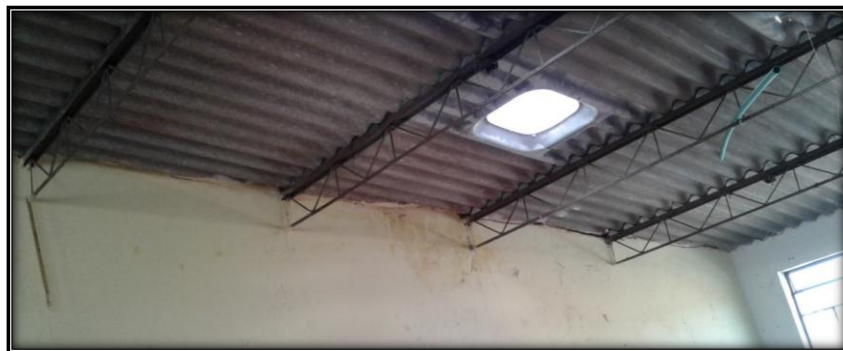
Ilustración 31 Estado de la cubierta de la institución.
