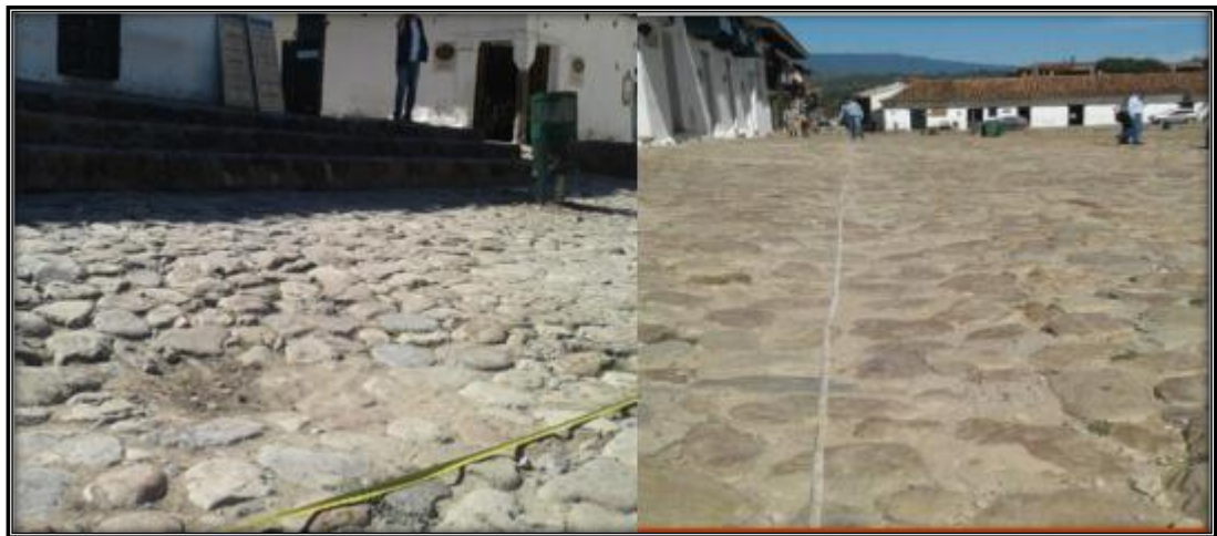
Ilustración 20 Hundimiento de empedrado
