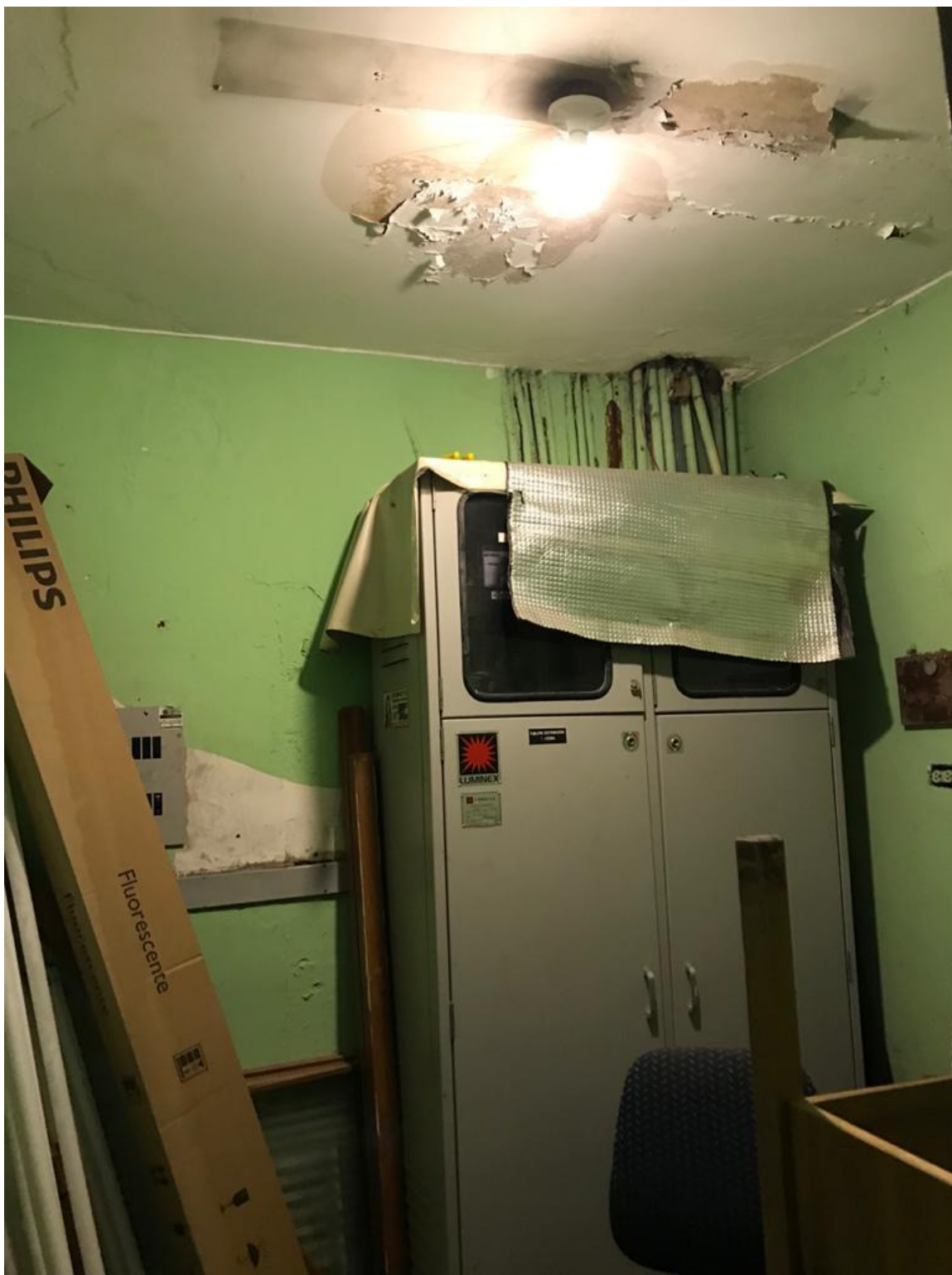
Anexo 6. Tubería de aguas residuales en subestación.
