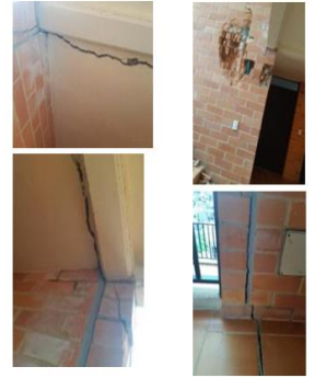
Finalmente, se menciona en el informe que la Torre 5 de estudio presenta diversas patologías en su estructura a causa de tres principales factores, inicialmente los estudios previos no fueron tenidos en cuenta para el proceso constructivo especialmente el estudio de suelos y recomendaciones del geotécnico, lo segundo es que para todo el predio se diseñó muros tipo y una torre tipo independientemente de la topografía y condiciones especiales del suelo y para finalizar probables los
