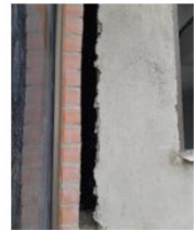
Fotografía 5: Dilatación entre construcción en proceso y casa afectada
