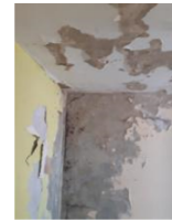
Fotografía 1: Humedad muro colindante con construcción en desarrollo
