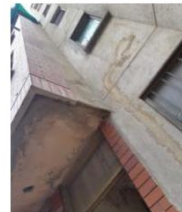
Fotografía 6: Daño a fachada con material de obra
