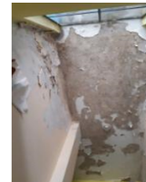
Fotografía 2: Humedad placa entrepiso
