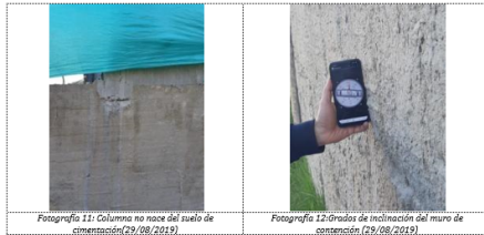
Fotografía 11: Columna no hace del nivel de cimentación(29/08/2019)
