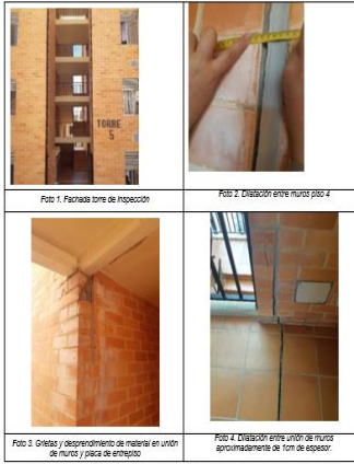
Se observa que en el muro interno presenta agrietamiento paralelo a las uniones de espesor aproximado 1 cm en el piso tres (3), el cual aumenta hasta aproximadamente >2 cm en la placa del último nivel, sin embargo, el agrietamiento se observa igualmente en las placas de entablo de las escaleras, también desprendimiento de material de mampostería en muros estructurales, las escaleras se encuentran con un elemento independiente el cual no es parte del sistema de
